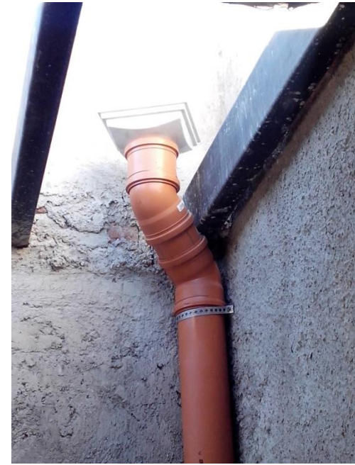
Desagüe pluvial por medio de embudo y conducto de PVC
