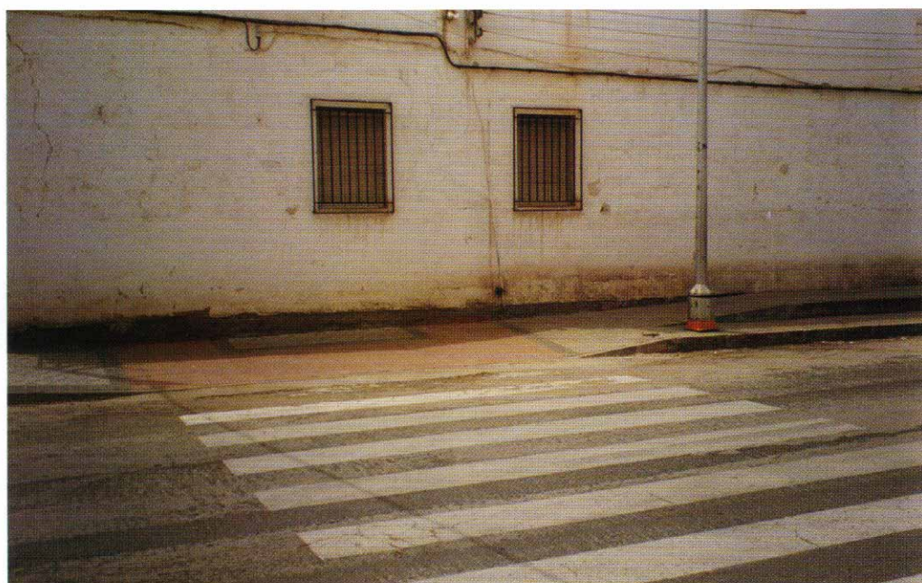
Foto 5: Paso peatonal con vado de ruptura de nivel
