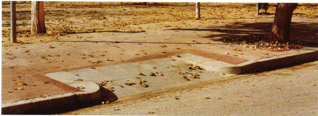
Foto 9: Vado de una rampa sin protección de cuchillos laterales
