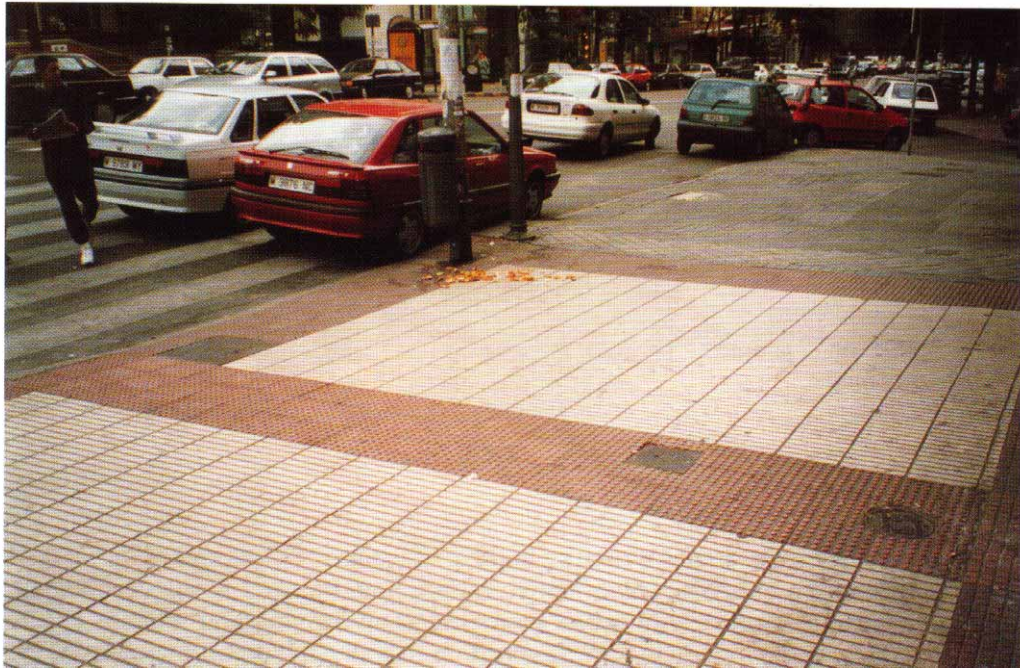
Foto 8: Vado de tres rampas con dos bandas señalizadoras laterales construido con "pavimento" de botones" de color contrastado con el itinerario peatonal en que se ubica
