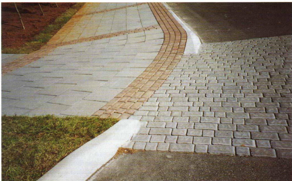
Foto 2: Detalle de vado de resalte
