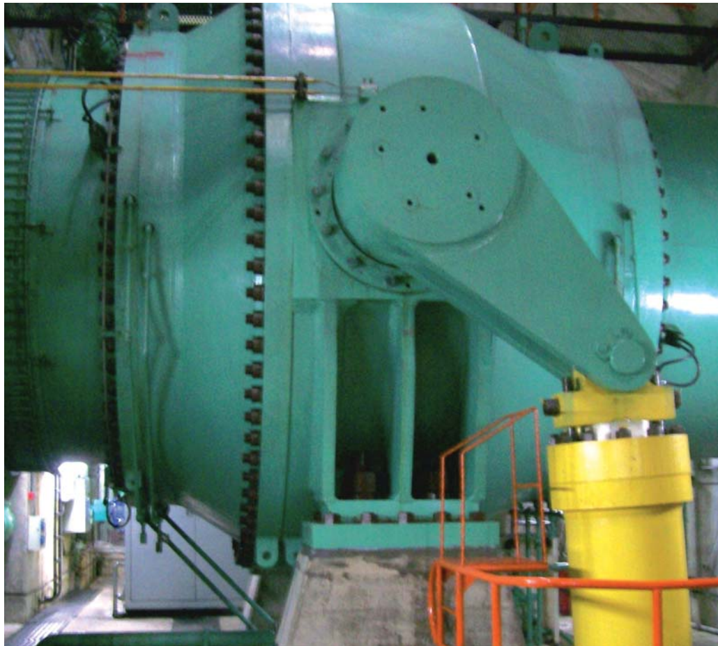
Vista de una de las válvulas mariposa, previa a la cámara espiral de las turbinas.
