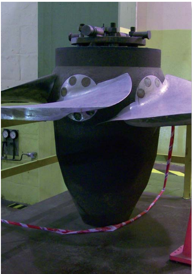
Vista de un rodete de la turbina Kaplan. Actualmente se ha modificado la segunda turbina y se ha transformado en tipo Voith.
