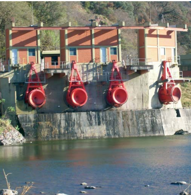
Vista de válvulas de chorro hueco, a la salida del descargador de fondo.
