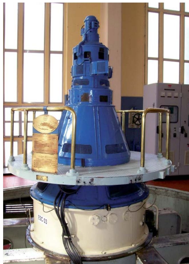
Vista en detalle de uno de los generadores.
