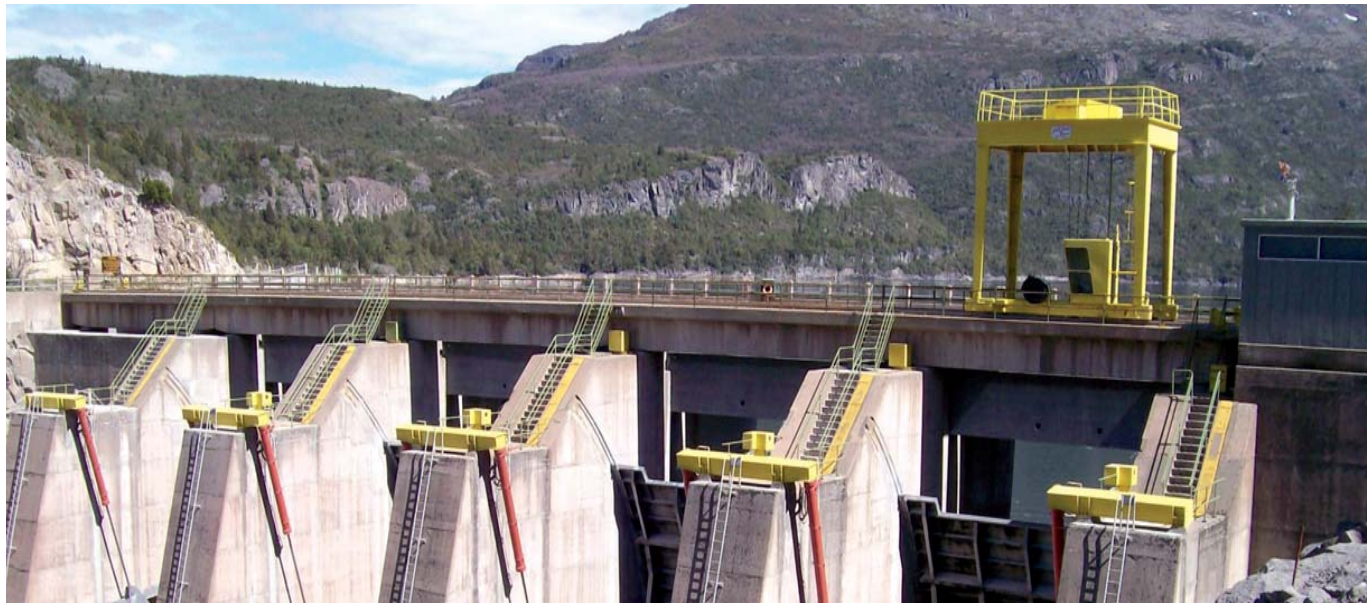
Vista del vertedero con las cuatro compuertas de segmento y sus elementos de accionamiento. Nótese las ataguías sobre cada compuerta.
