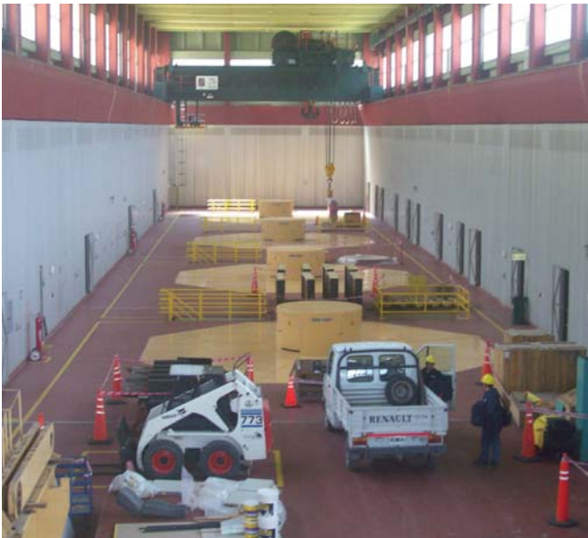
Vista de los grupos generadores de la central.
