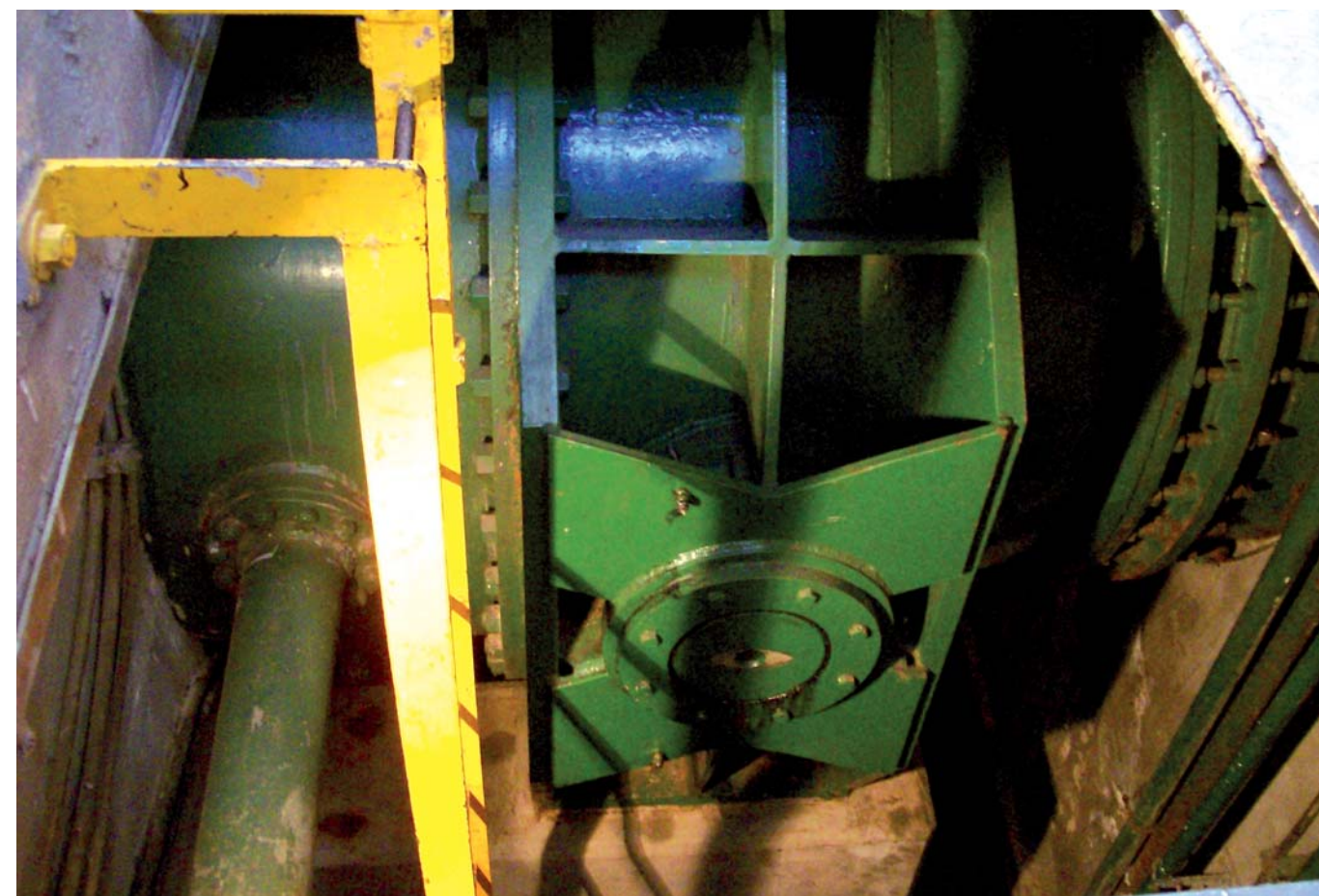
Vista de la válvula mariposa de ingreso a la cámara espiral de las turbinas.
