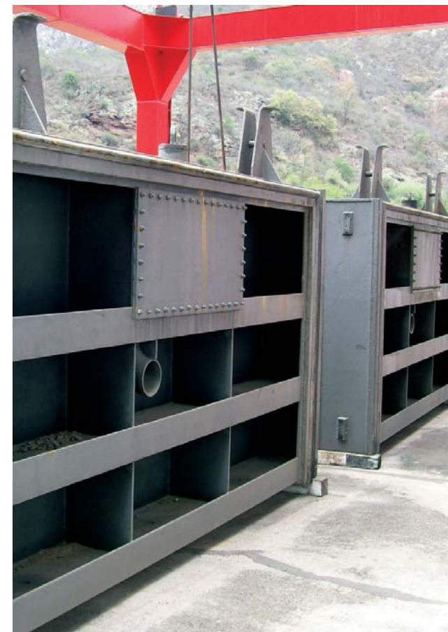
Vista de las ataguías de restitución de la central, con su puente de accionamiento.
