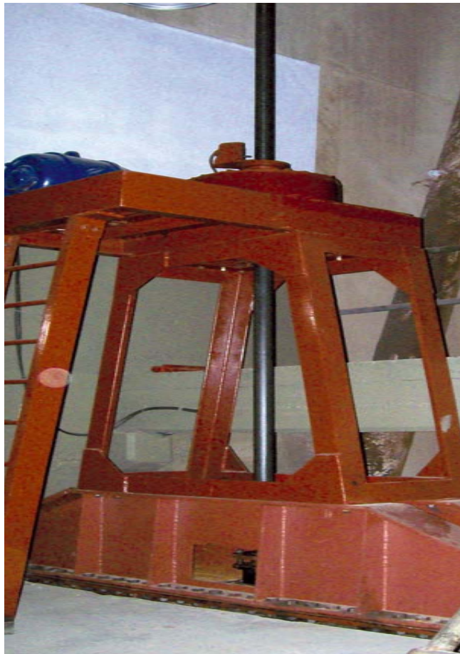
Vista del mecanismo de cierre de la compuerta de uno de los dos descargadores de fondo.
