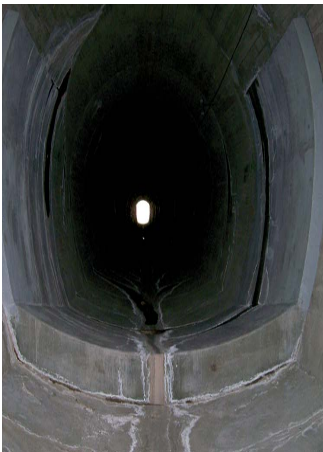
Detalle de uno de los aireadores, realizados posteriormente a la construcción del túnel.
