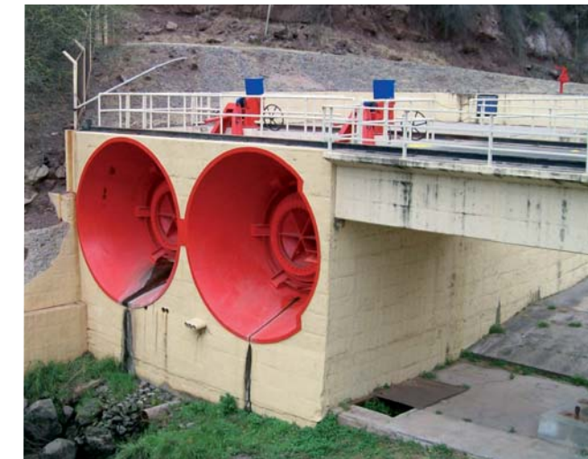
Vista de las válvulas de chorro hueco del descargador de fondo.
