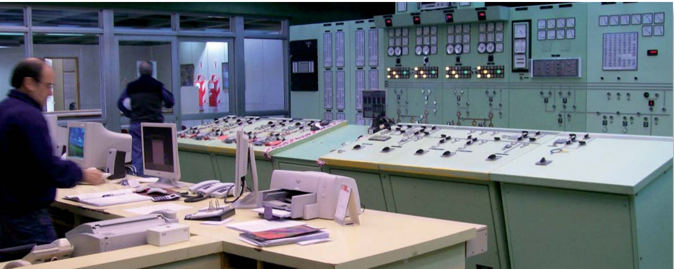
Vista general del tablero de la sala de comando de la central.
