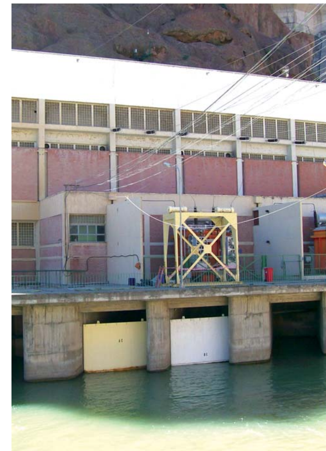
Vista de la salida de la central y del canal de restitución al río. Nótese las ataguías para el cierre, correspondientes al grupo en mantenimiento.
