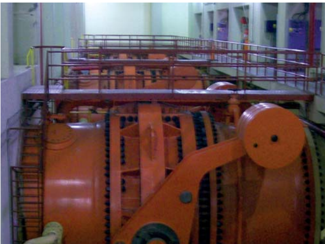
Vista de las válvulas mariposa de ingreso a la cámara espiral.
