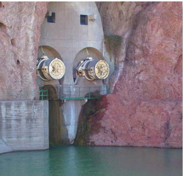
Vista de la descarga para riego con las válvulas de chorro hueco.
