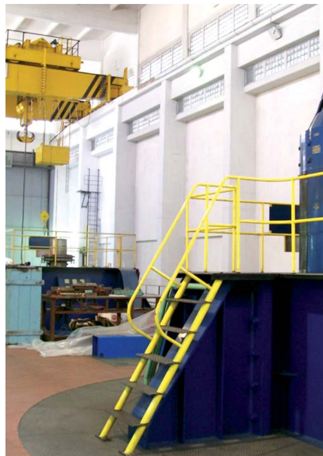
Vista de la central con un grupo en funcionamiento y el otro en mantenimiento.
