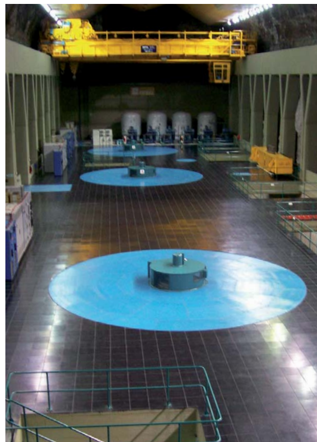
Vista de la central con tres de las cuatro turbinas.
