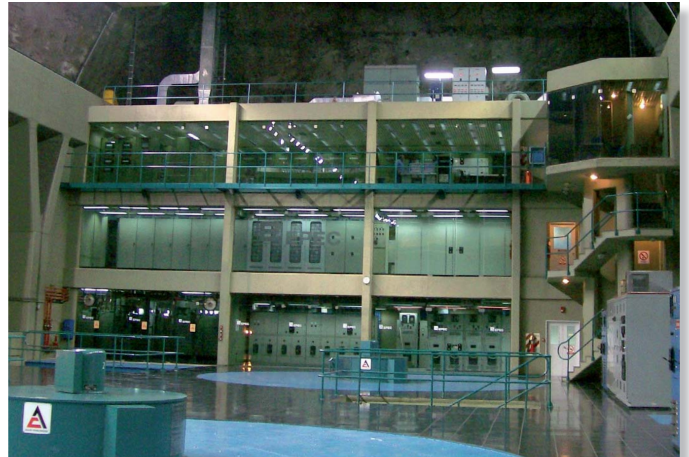
Vista de la central con la sala de control en el piso superior al fondo.
