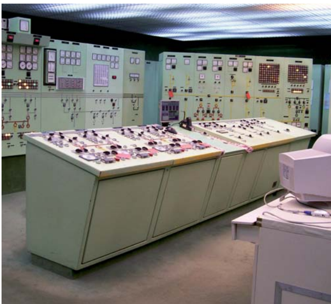
Vista general del tablero de la sala de comando de la central.
