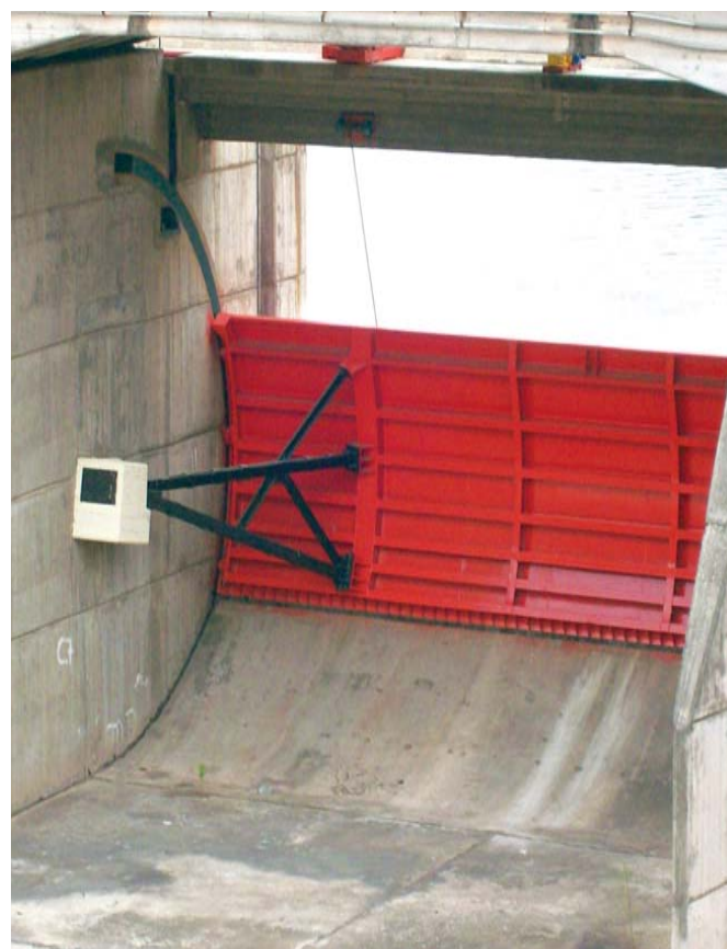
Vista de detalle de una de las compuertas de sector. Nótese la curva de la solera.
