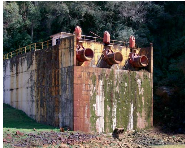
Vista del macizo de válvulas de los descargadores de fondo y riego.
