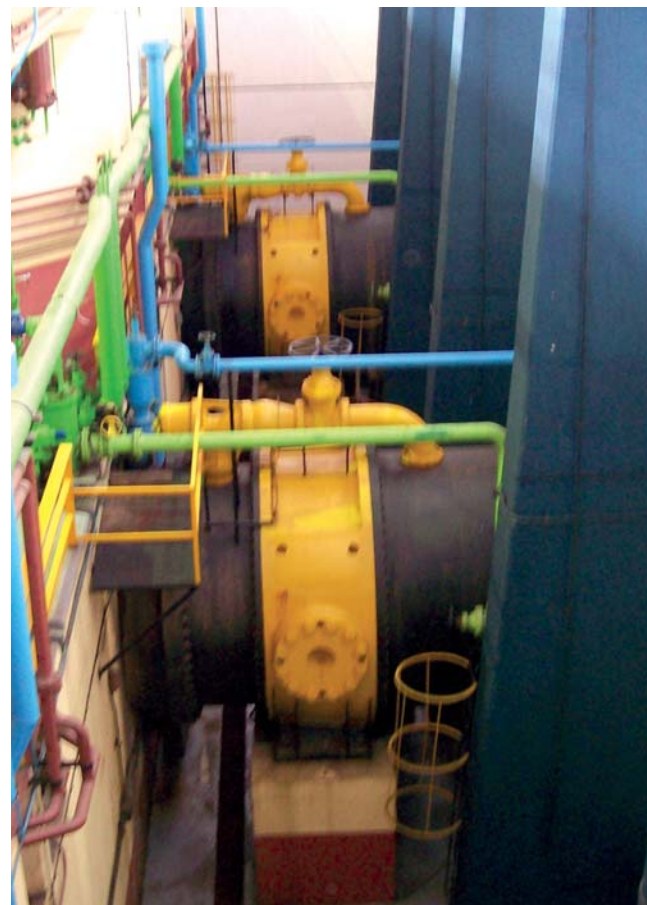
Vista de dos de las tres válvulas mariposa, previas a la cámara espiral.
