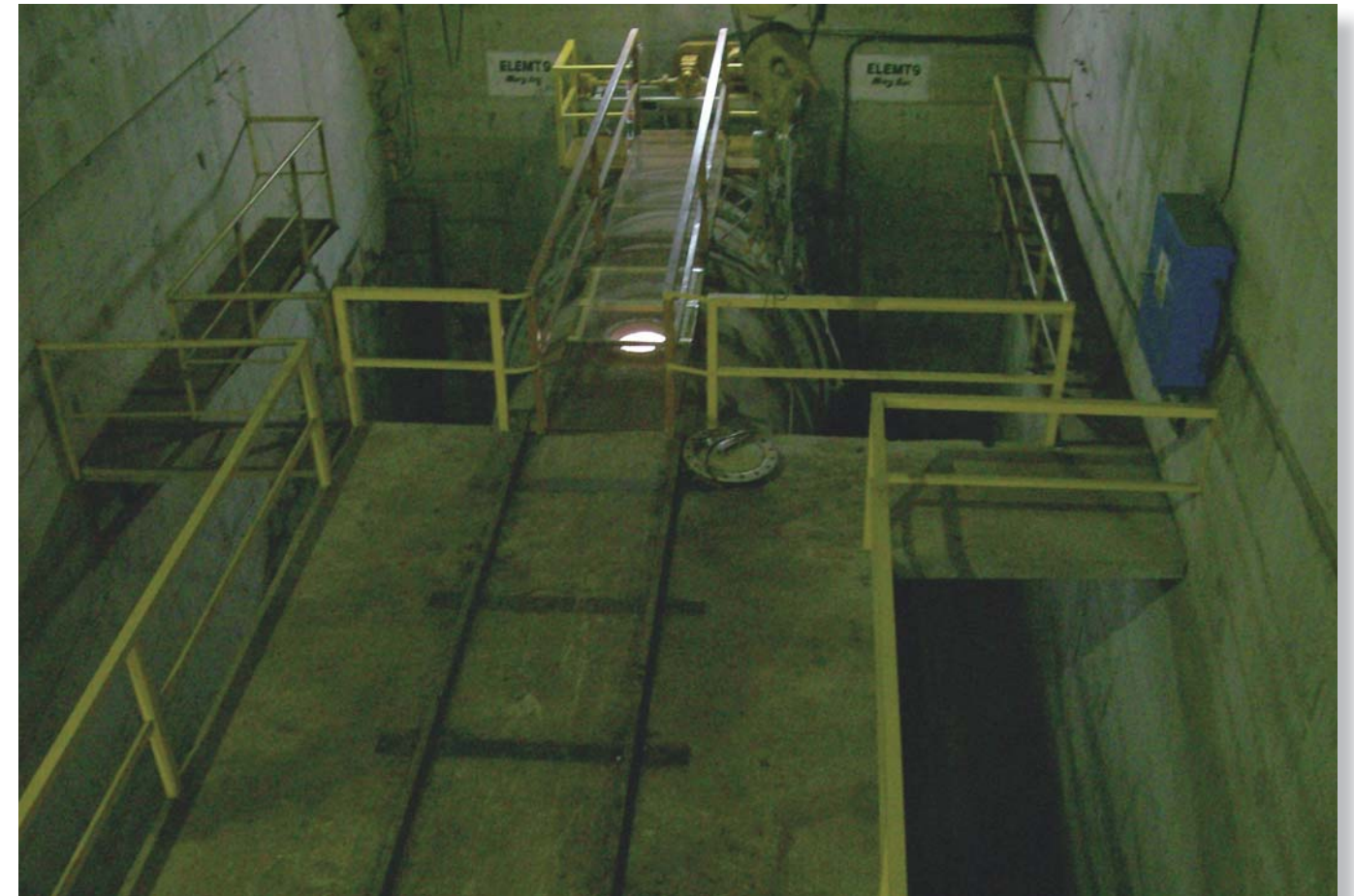
Vista del inicio de la conducción de la derivación para riego y de la válvula mariposa de accionamiento.
