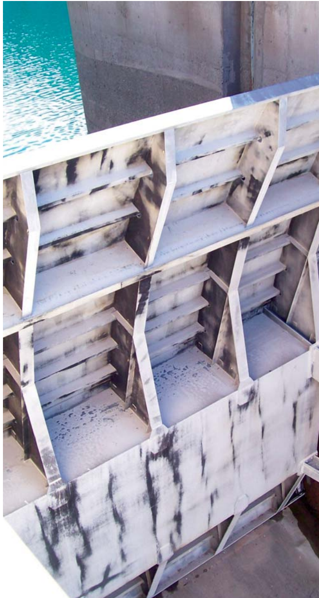
Detalle de compuerta de segmento.
