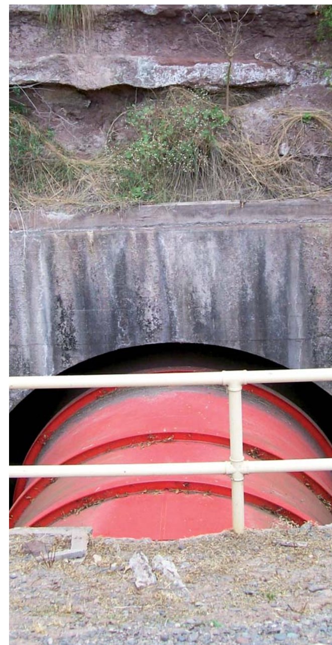
Salida de la conducción del descargador de fondo, antes de las válvulas mariposas.
