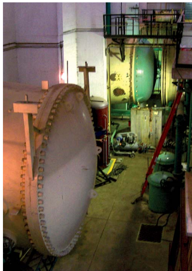
Vista general donde se aprecia, al fondo la válvula en funcionamiento, al centro el grupo en mantenimiento y al frente la tubería prevista para colocar un grupo adicional.
