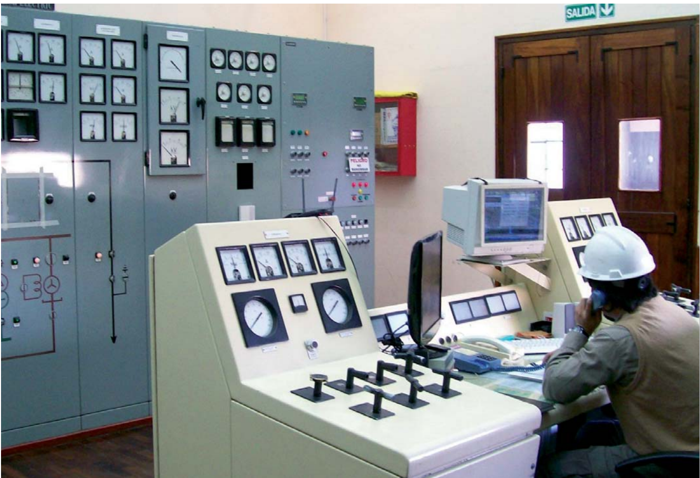
Vistas de la sala de control de la central.
