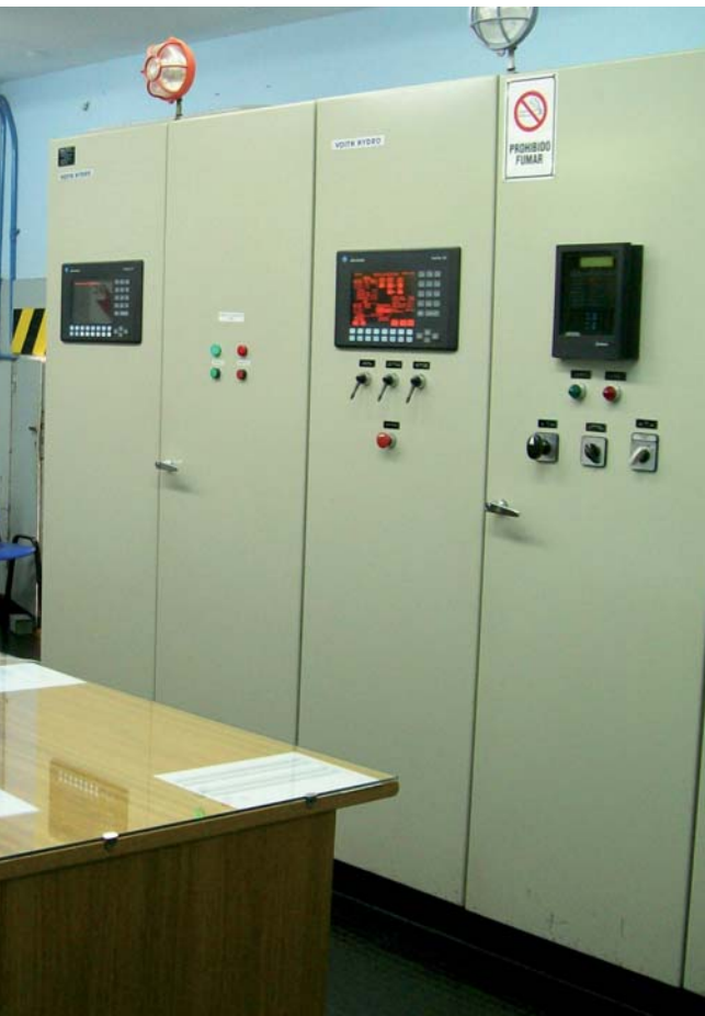
Vista de la sala de control.
