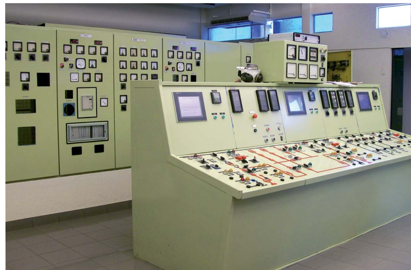
Vista general del tablero de la sala de comando de la central.
