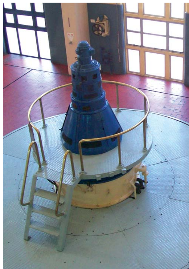
Vista de uno de los tres grupos generadores de la central.
