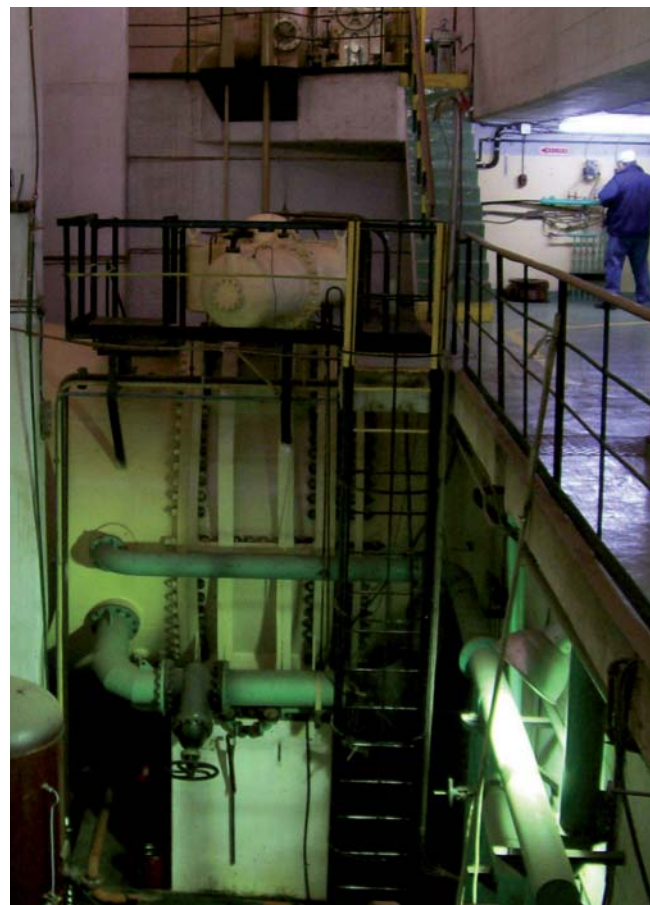
Vista de la válvula mariposa de la cámara espiral de la central.
