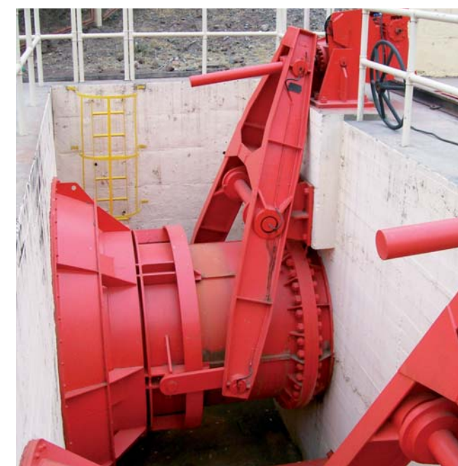
Vista del mecanismo de apertura de las válvulas de chorro hueco del descargador de fondo.
