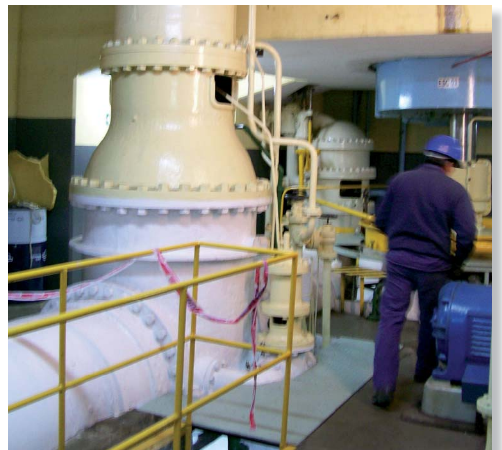
Vista de la válvula esclusa, previa a la cámara espiral de la turbina.
