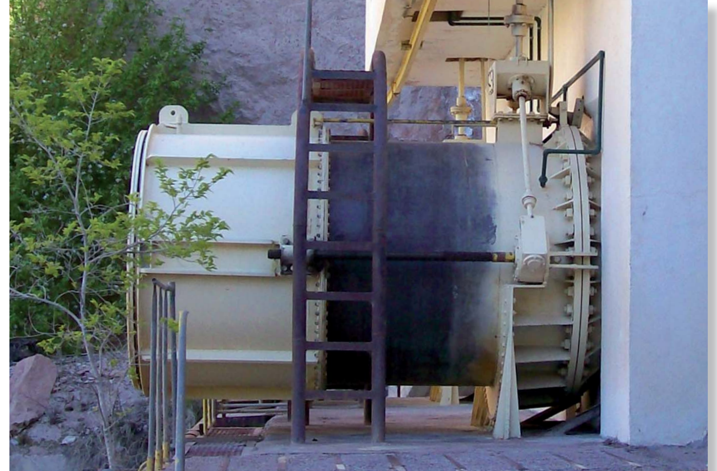
Vista de detalle de una de las válvulas de chorro hueco, con su mecanismo de accionamiento.
