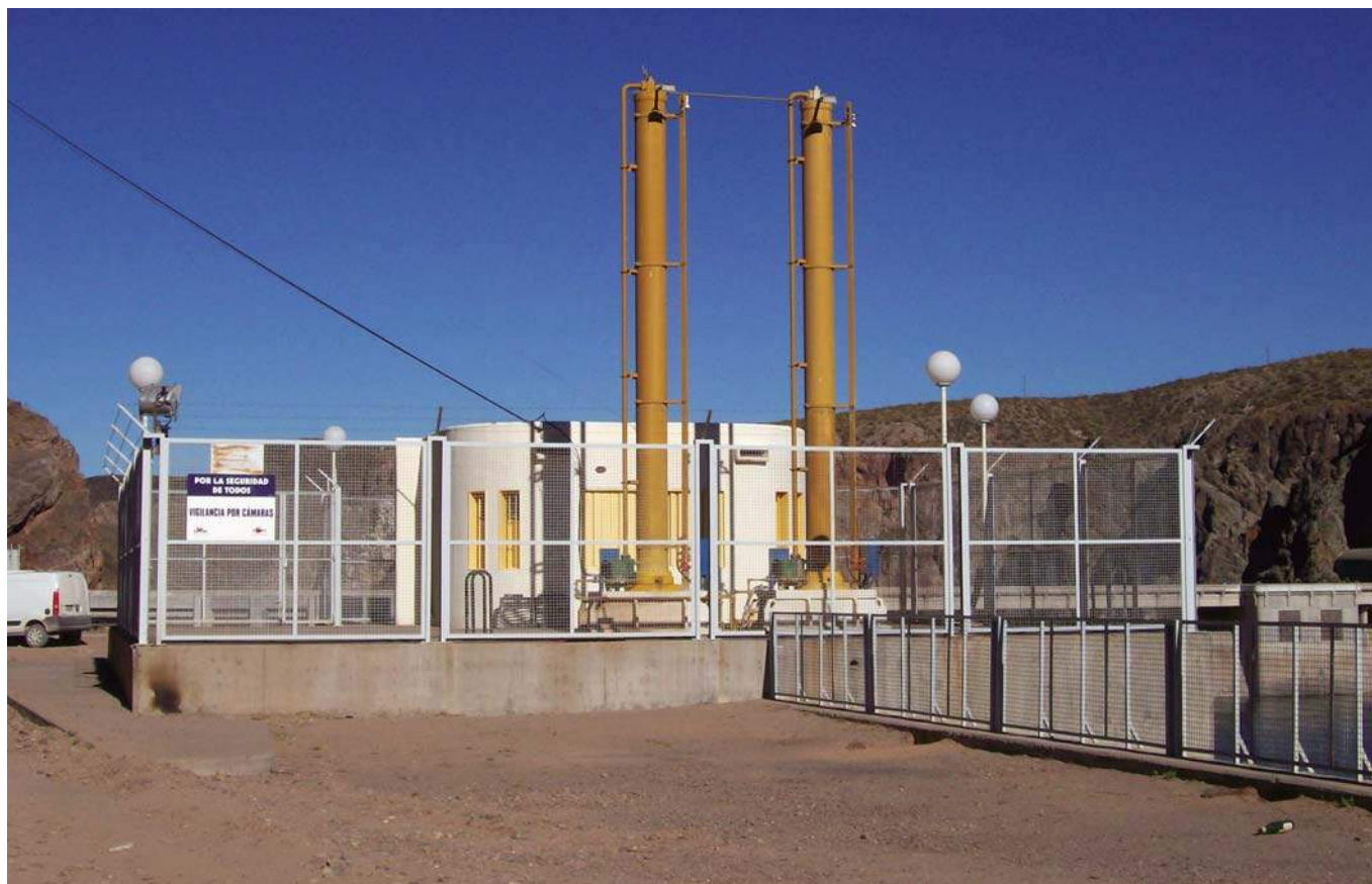
Vista en detalle del sistema de accionamiento hidráulico para las compuertas de obra de toma a central.
