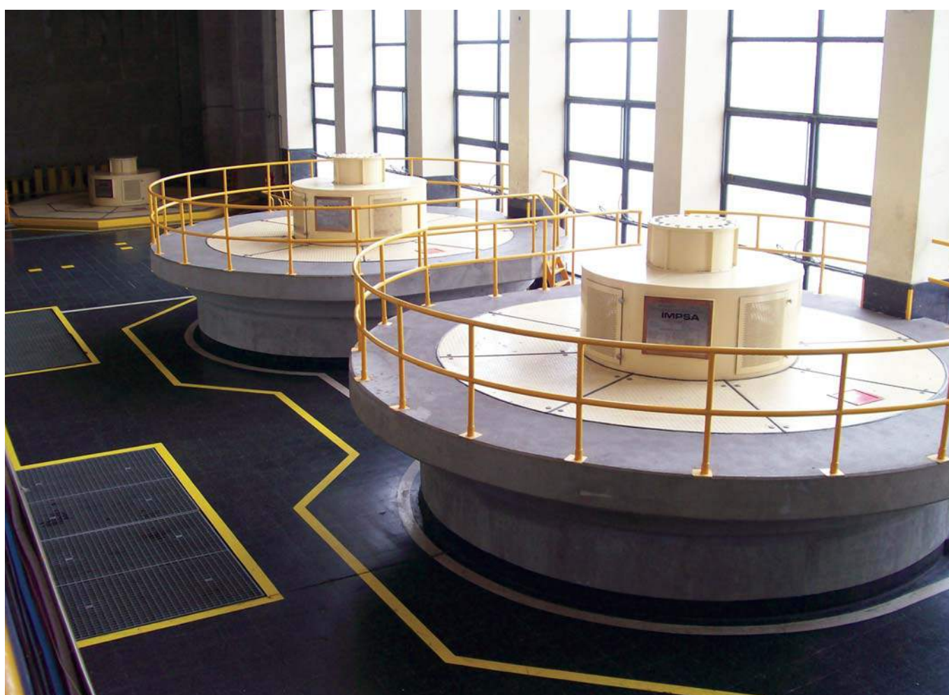
Vista de la central y de los tres grupos generadores. Los dos grupos al frente, son los instalados inicialmente.
