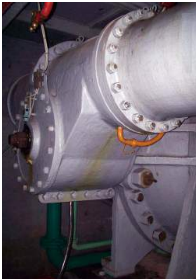
Vista de la válvula esférica y su accionamiento, previo al ingreso del agua a la cámara espiral de las turbinas.
