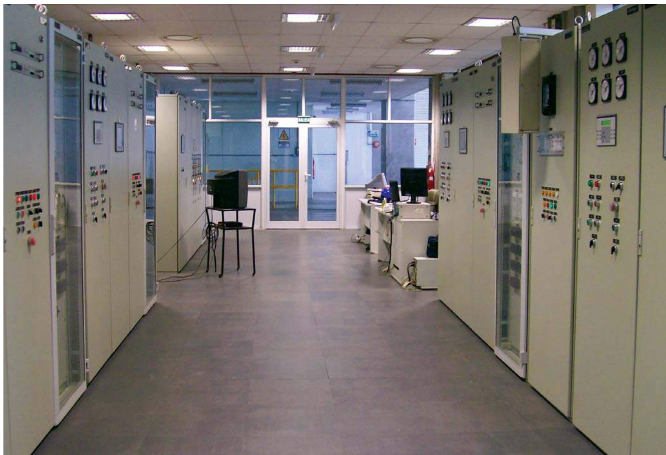
Vista sala de control.
