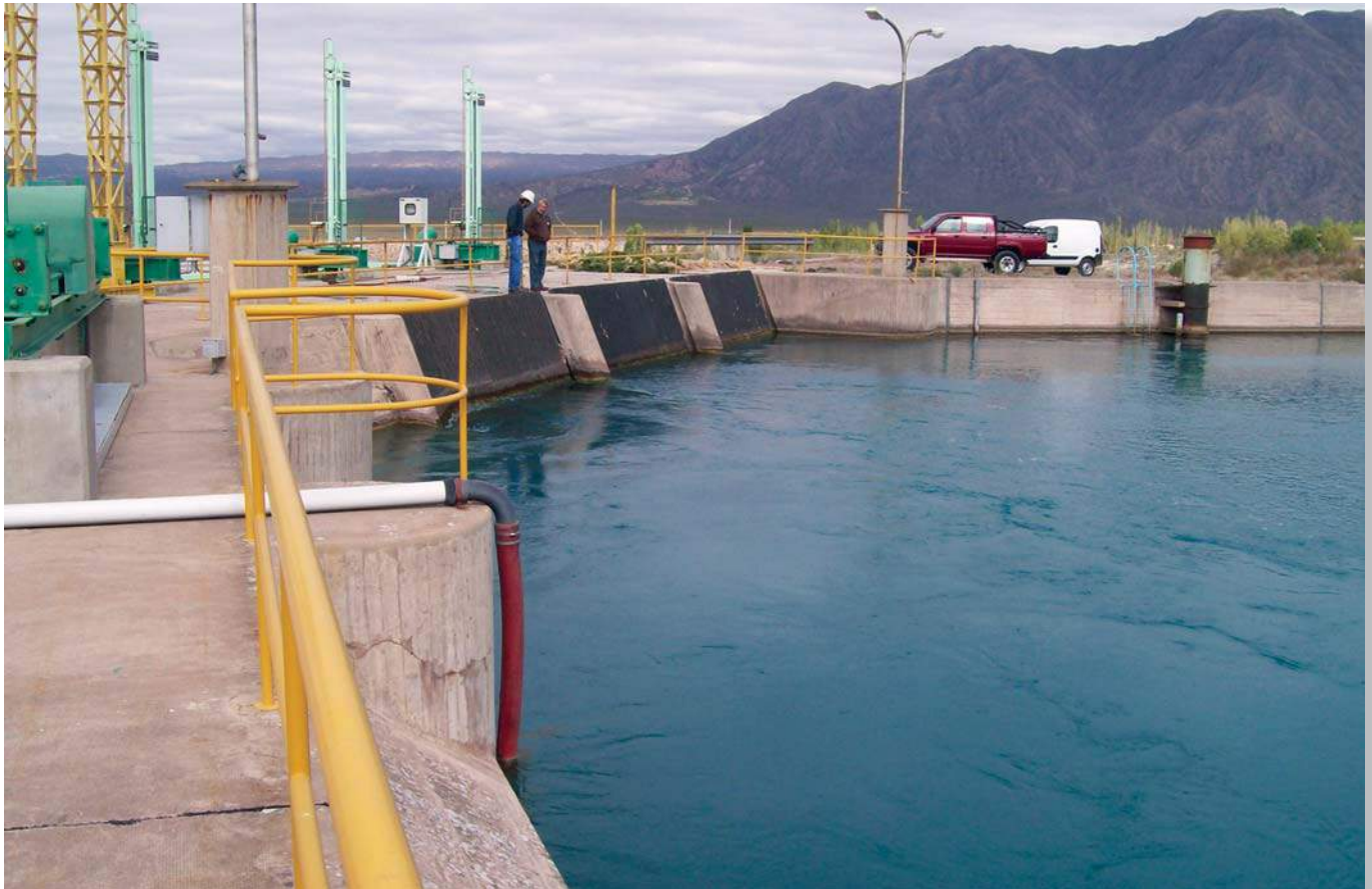
Vista de las rejillas y de los sistemas de accionamiento de las tres válvulas mariposa de los conductos.
