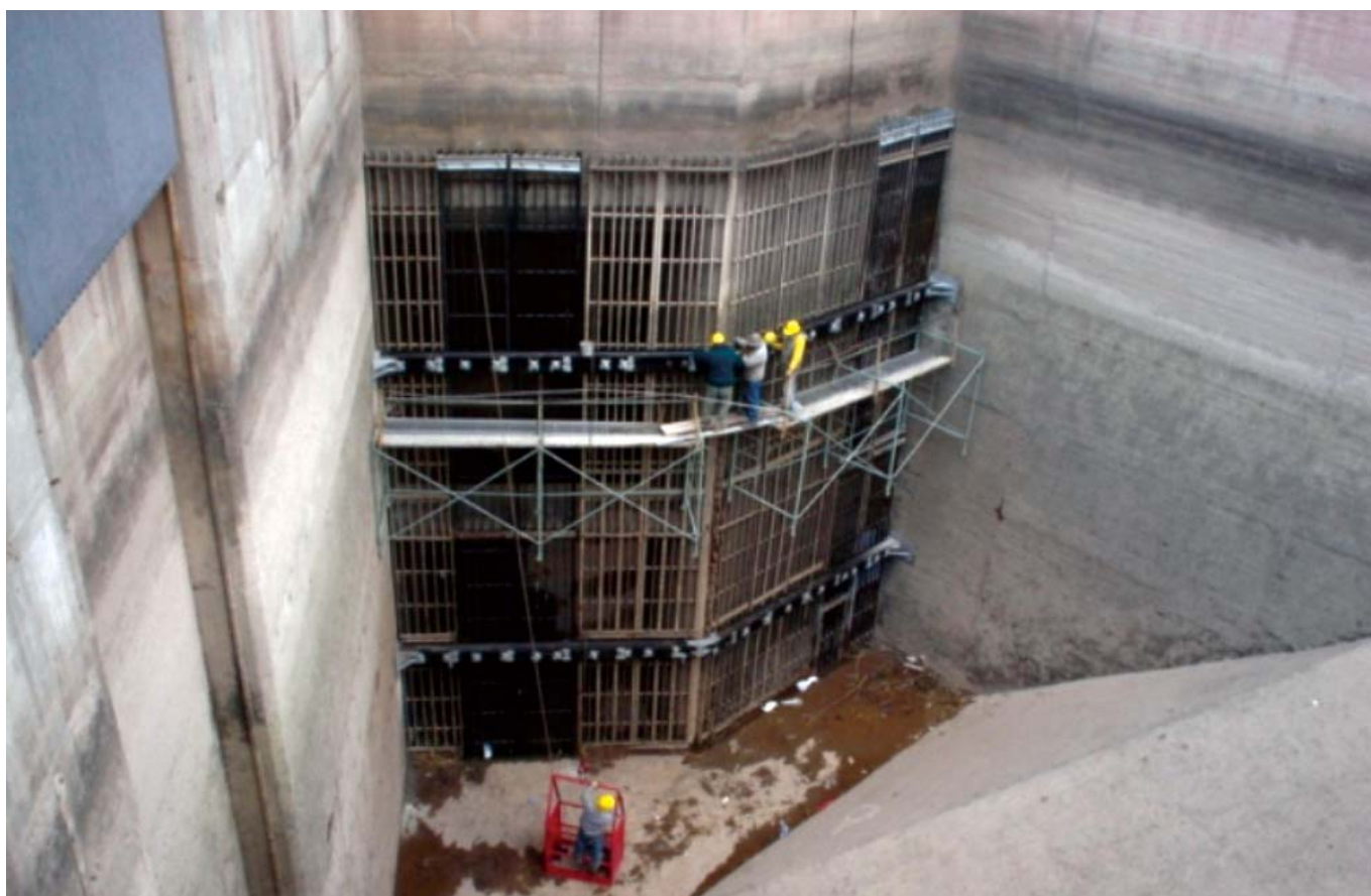
Vista de la toma de la conducción a la central con sus rejas. Nótese a la izquierda la compuerta de cierre para uno de los descargadores de fondo (Gentileza HINISA).
