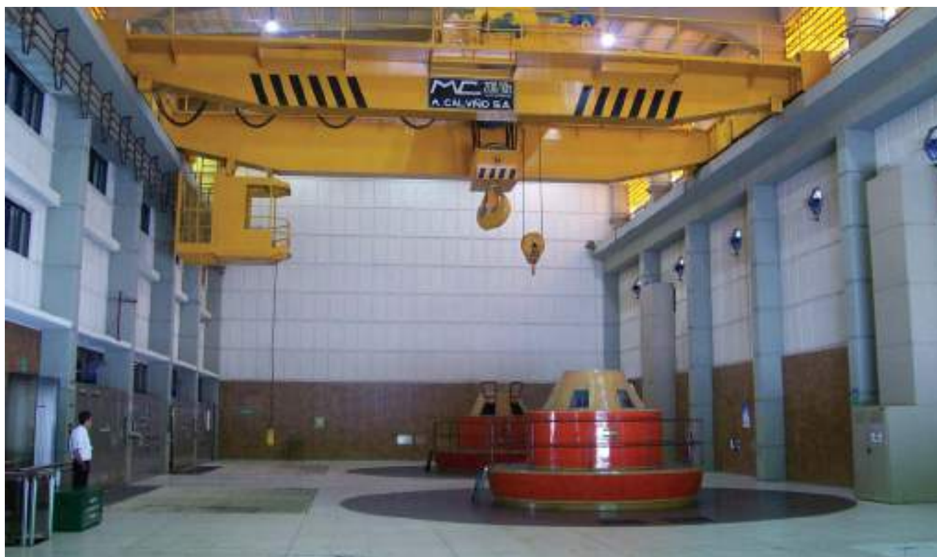
Vista general de la central con sus grupos generadores y elementos de izaje.
