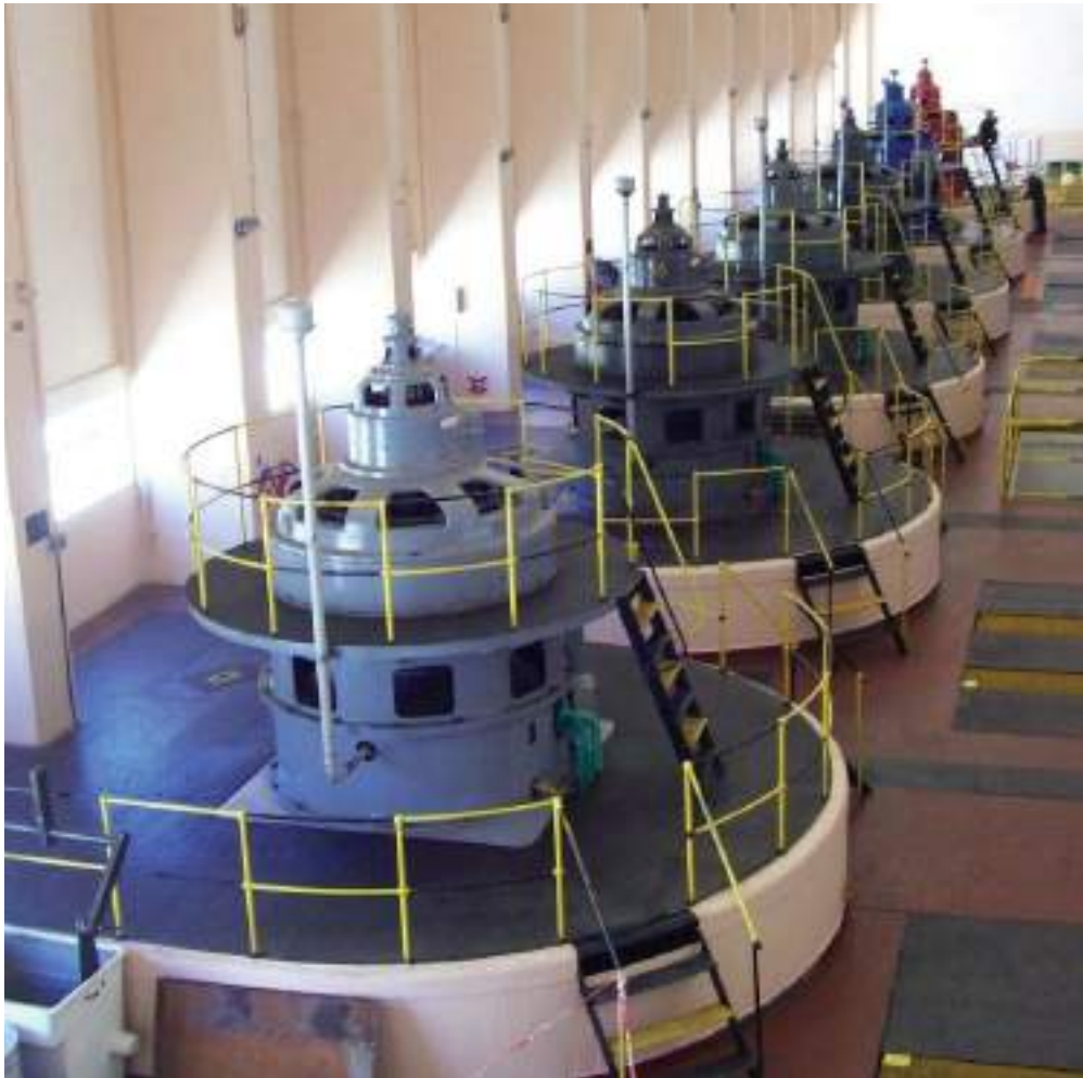
Vista de las seis generadores de la central Nihuil II.
