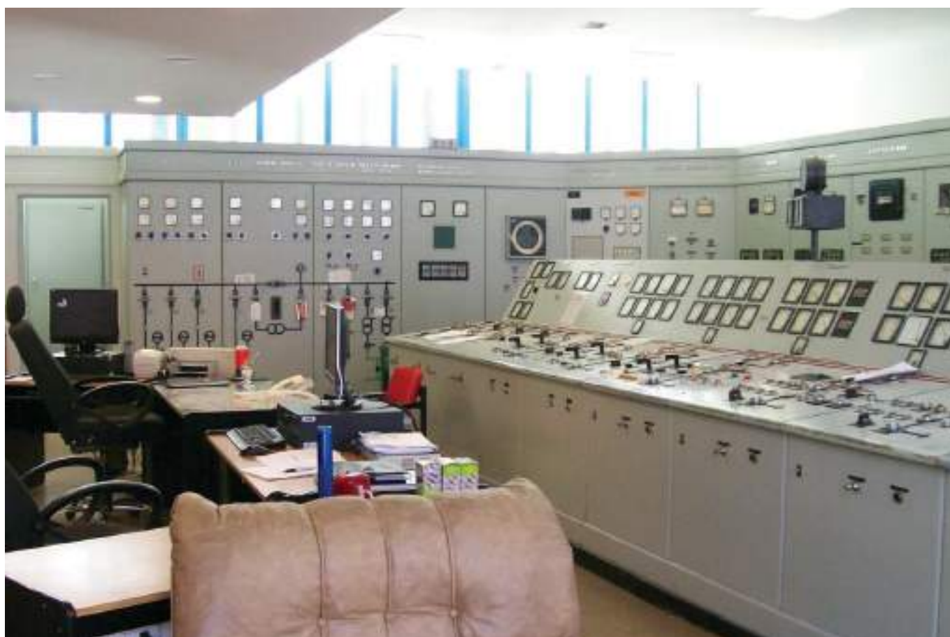
Vista general de la sala de comando.
