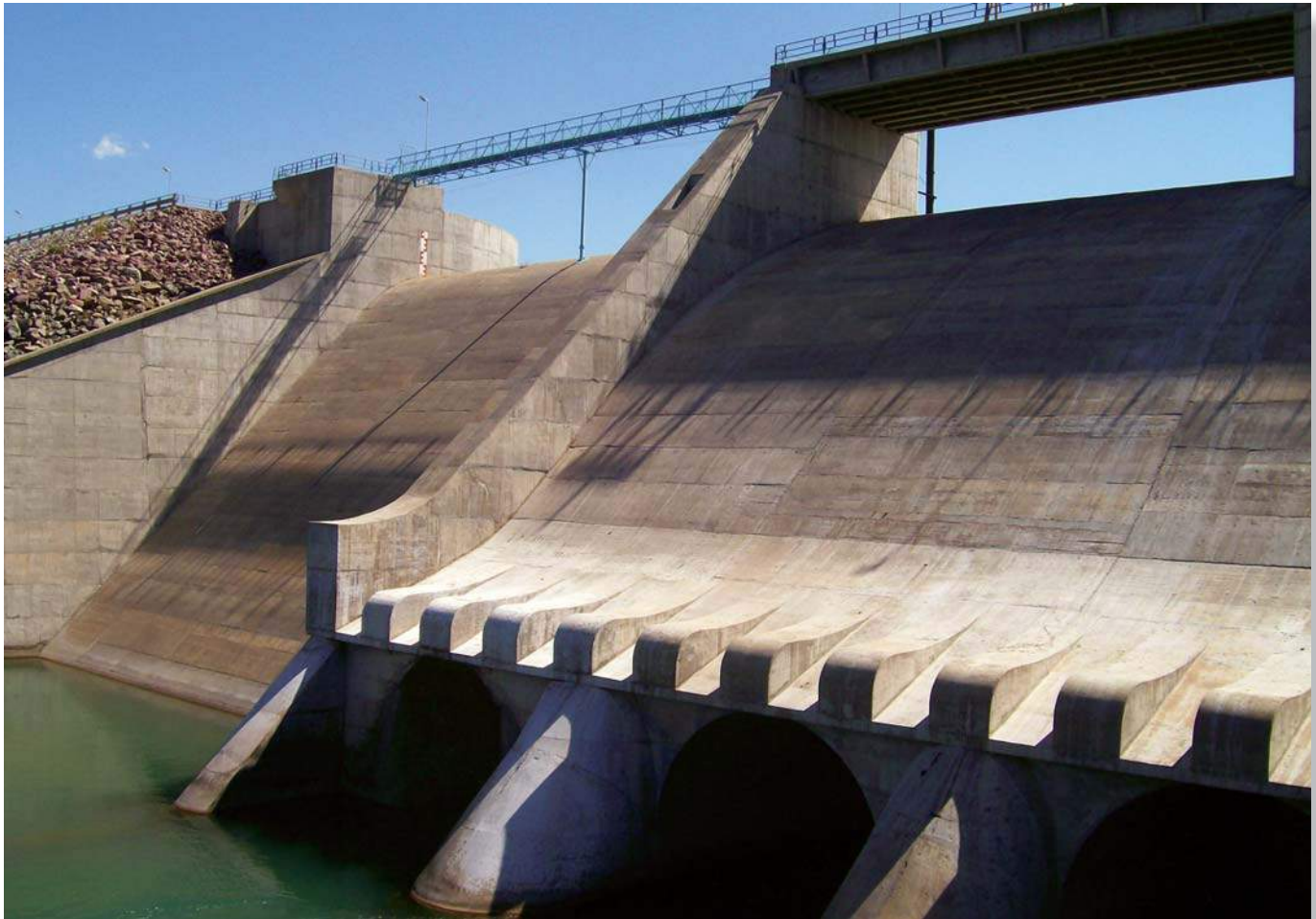
Vista del aliviadero completo. Se pueden apreciar las salidas y el sistema de disipación sobre el canal de restitución de la central y de la derivación para riego.
