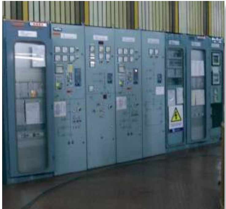
Vista del tablero de control de las turbinas y central. Este complejo también se puede manejar desde Los Reyunos, vía telecomando.
