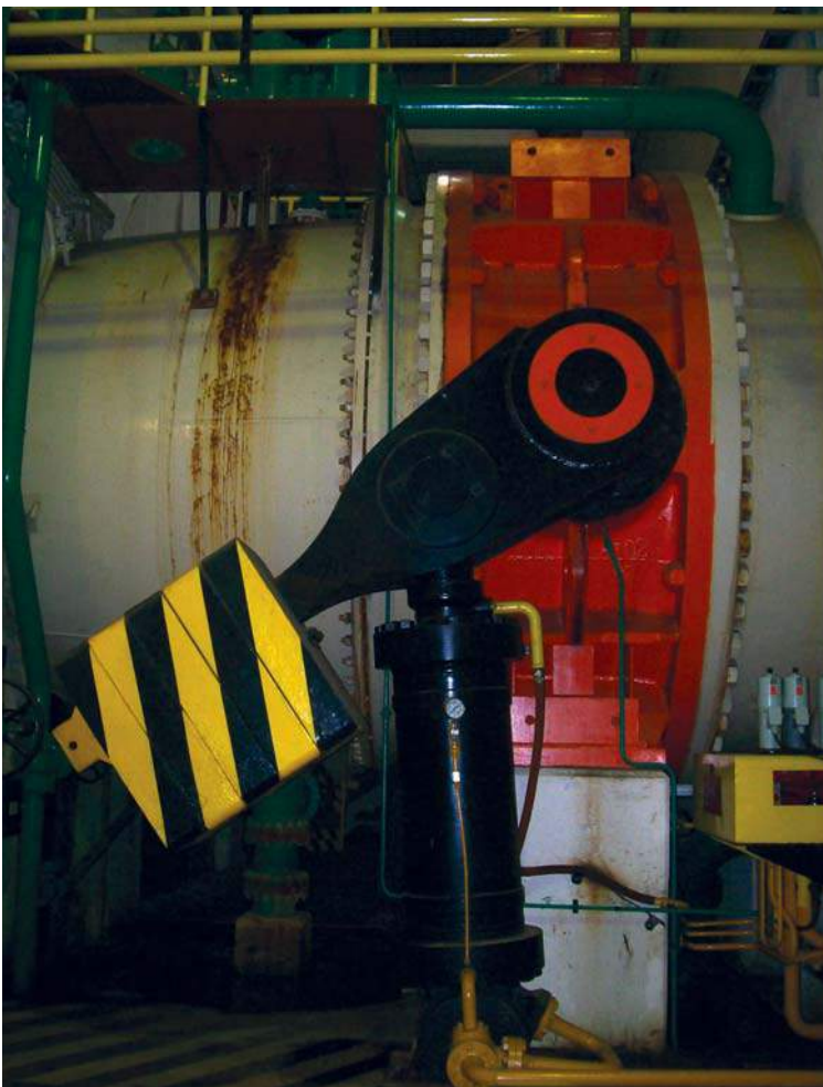
Vista de la válvula mariposa de cierre de la conducción de alimentación de la cámara espiral, con su contrapeso y sistema de accionamiento hidráulico.
