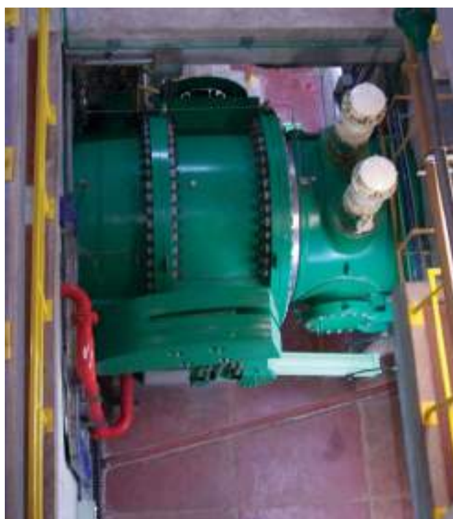
Vista de la válvula mariposa de cierre previa a la cámara espiral de las turbinas de la central Cacheuta.
