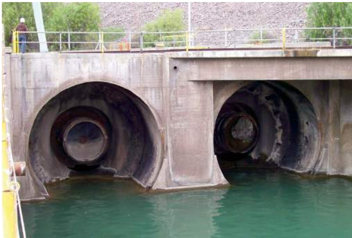
Vista de las válvulas de chorro hueco de la derivación de riego. Nótese el blindaje en acero a la salida de ambas válvulas.
