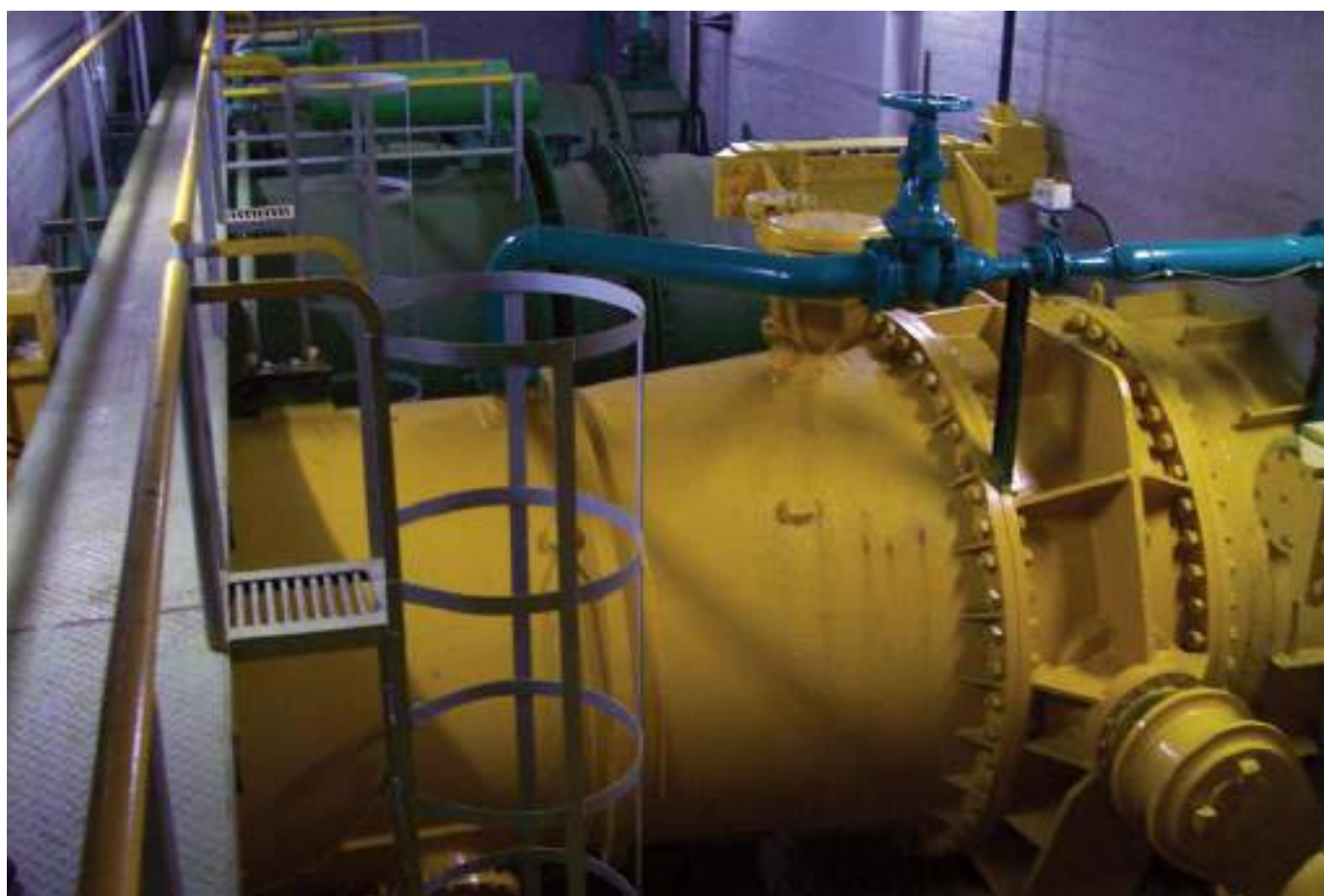
Vista de la casa de válvulas, al fondo se aprecian las válvulas de la conducción a la central y en primer plano, una de las destinadas a riego.
