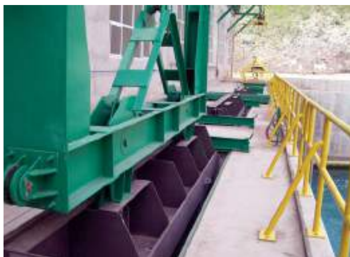
Vista de las compuertas de cierre de la dársena de restitución al río de la central Cacheuta.
