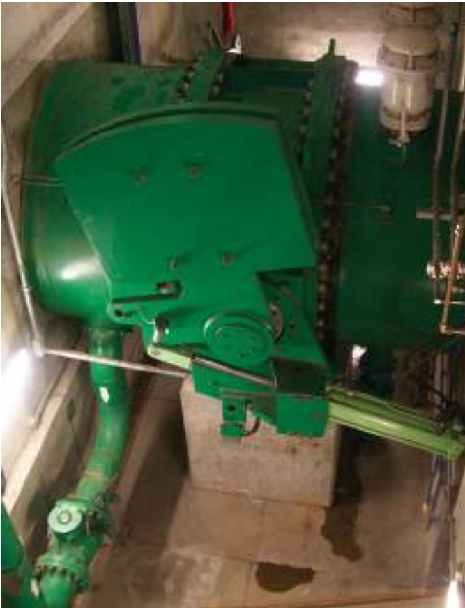
Vista de una de las válvulas mariposa previa a la cámara espiral.
