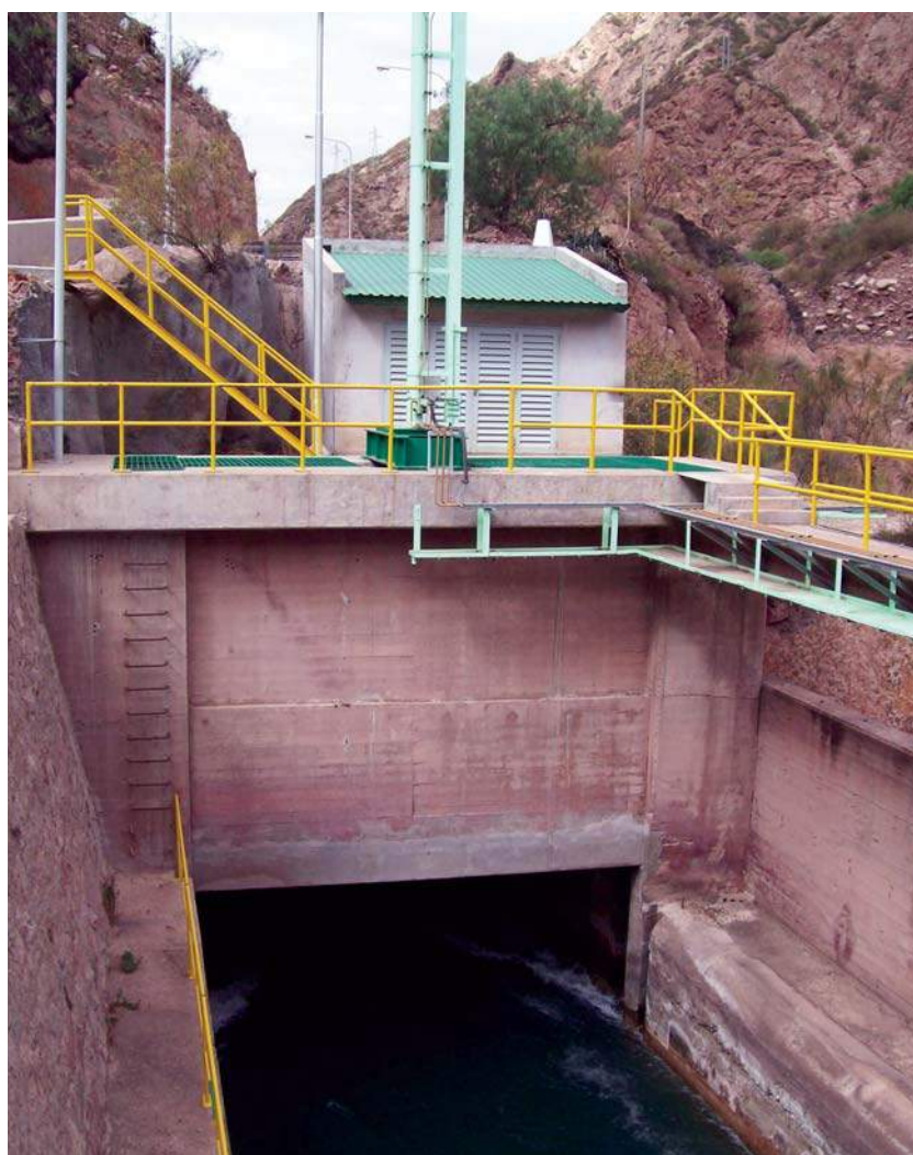
Vista de la casilla de comando de la compuerta de la conducción a la central.
