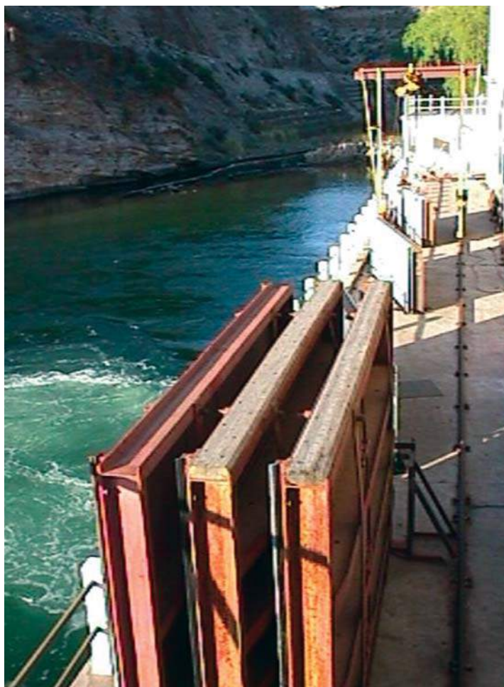
Vista de las compuertas de cierre del canal de restitución al río de la central Nihuil I (gentileza HINISA).
