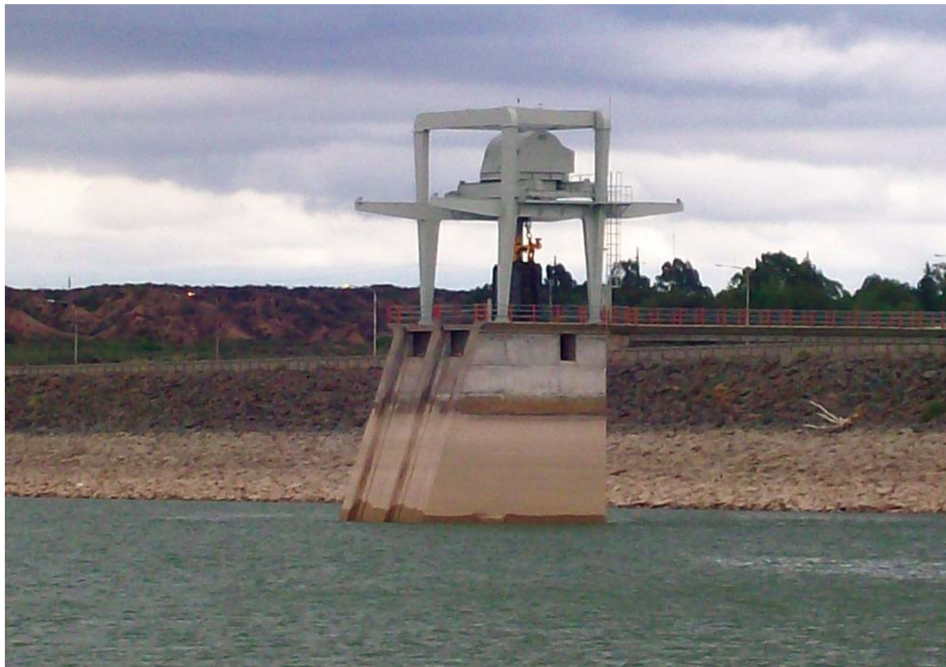
Vista de la obra de toma donde puede apreciarse las guías de las rejjas.
