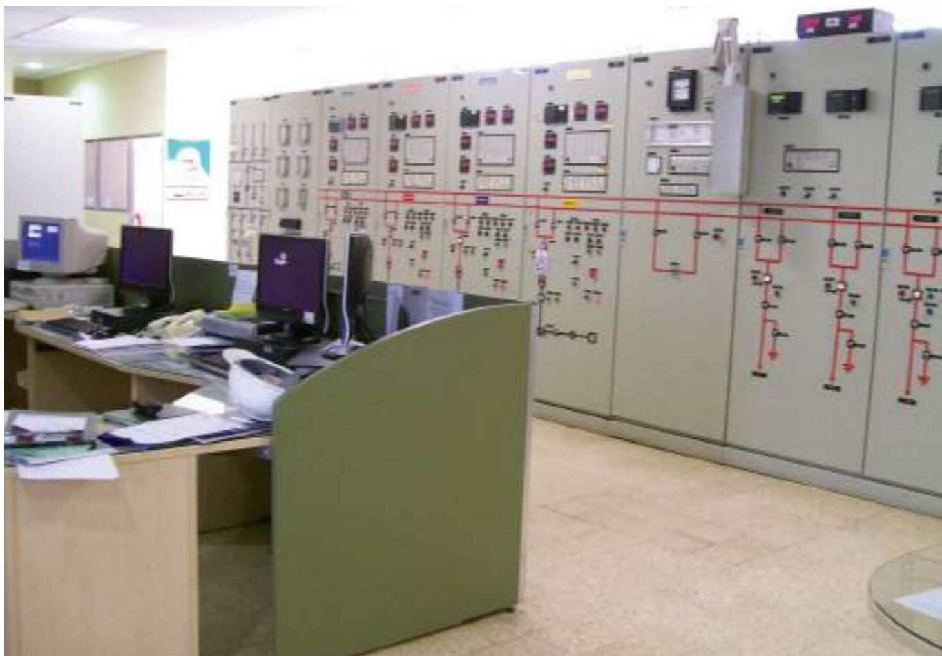
Vistas de la sala de control.
