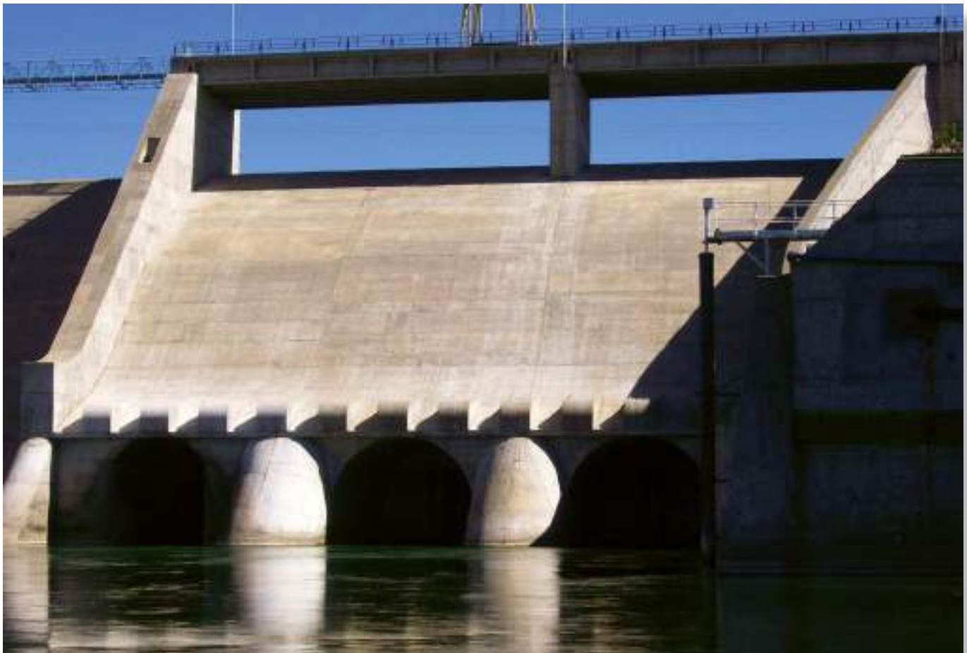
Vista de detalle del sistema de disipación de energía del aliviadero sobre tramo de la central.
