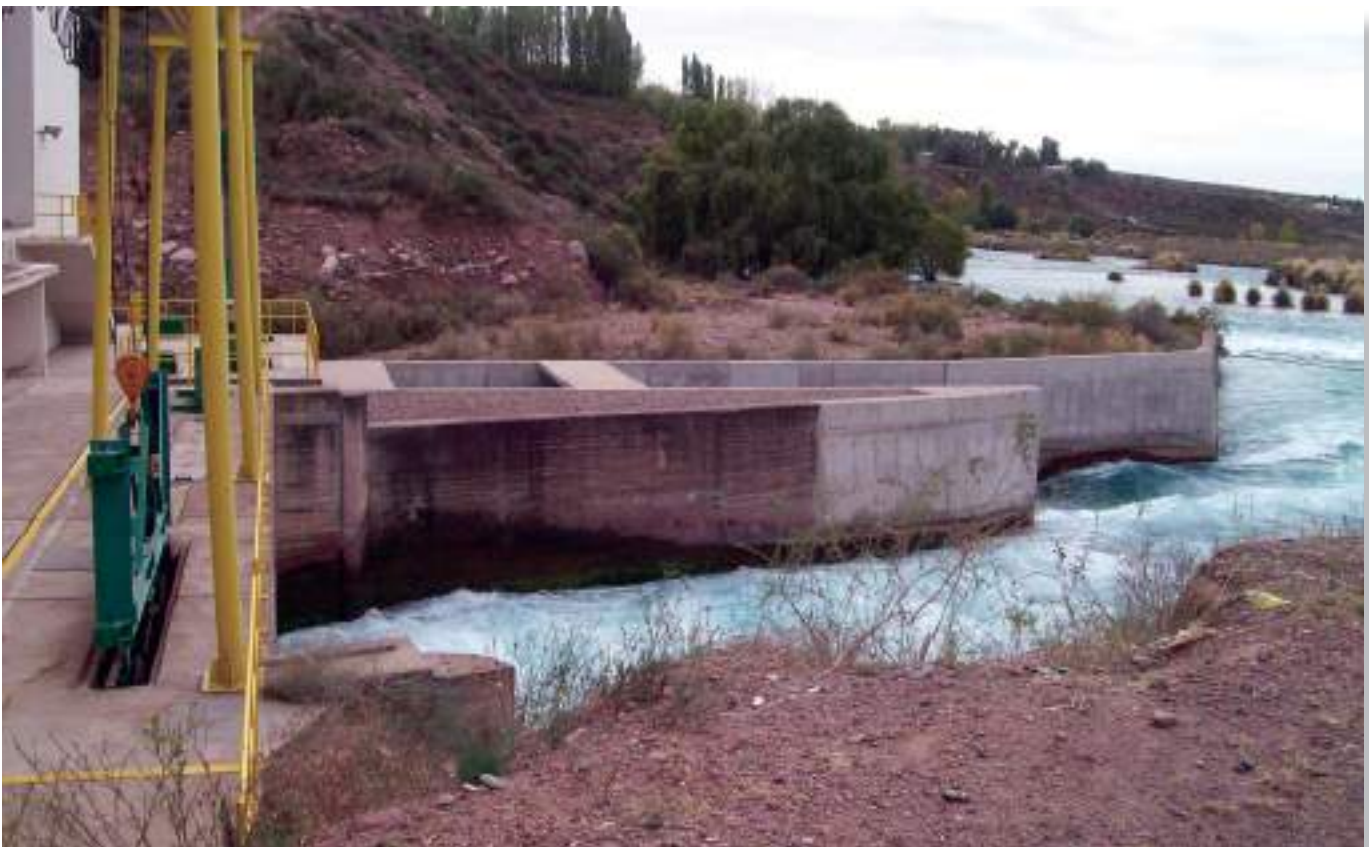
Vista del canal de restitución, se aprecia una de las compuertas que sirven como ataguías del mismo y su mecanismo de accionamiento.
