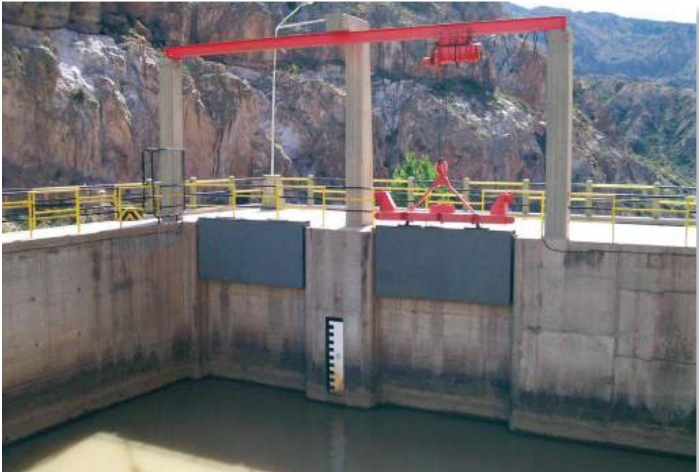
Vista de la toma de los descargadores de fondo. Obsérvese las compuertas de cierre.
