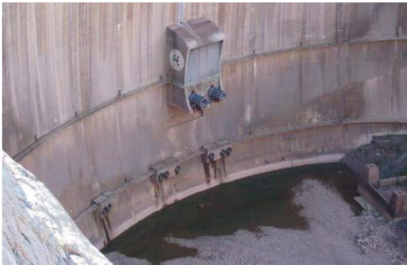
Vista en detalle de las válvulas de chorro hueco de las derivaciones de riego y ocho de los diez descargadores para sólidos en suspensión.
