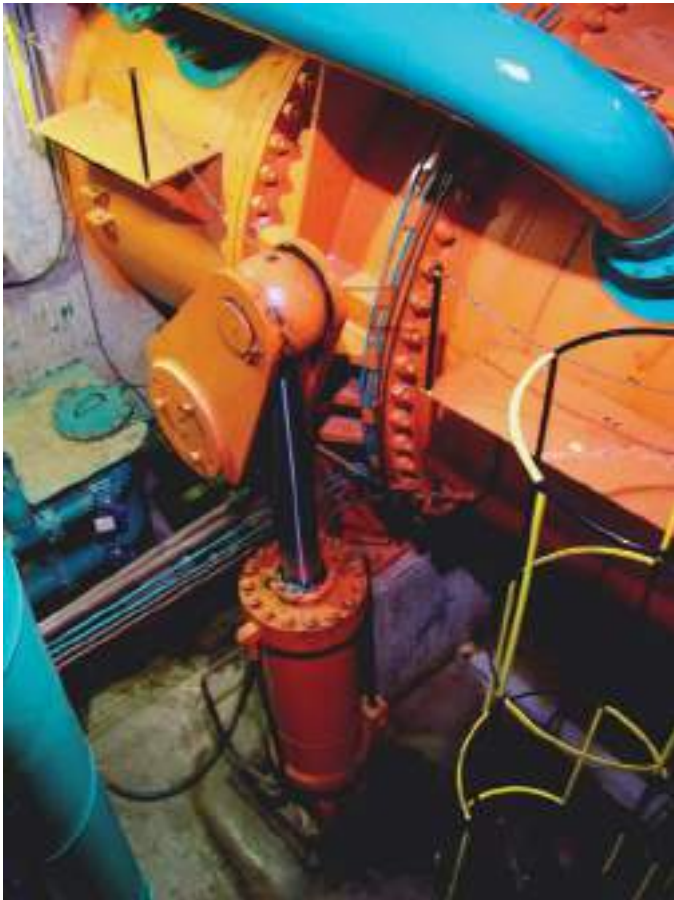
Vista de la válvula mariposa y de su sistema de accionamiento, previo al ingreso del agua en la cámara espiral.
