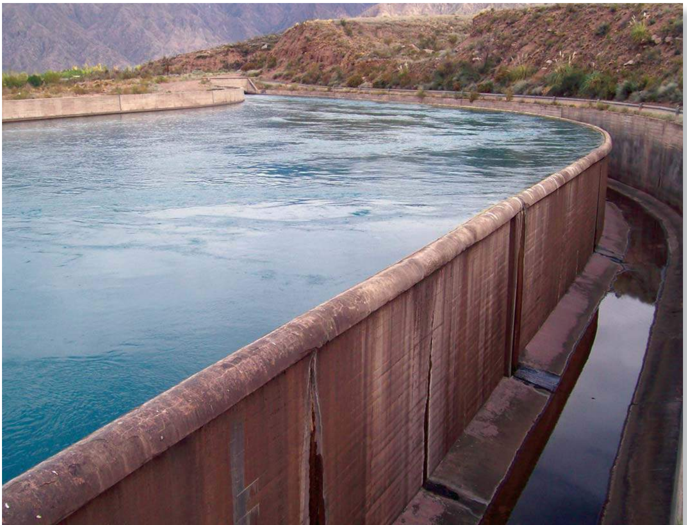
Vista de detalle del vertedero lateral que regula el nivel de la cámara de carga.
