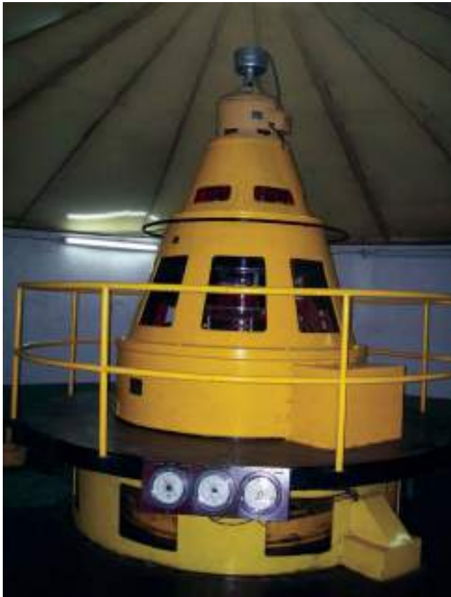
Vista de uno de los grupos generadores.
