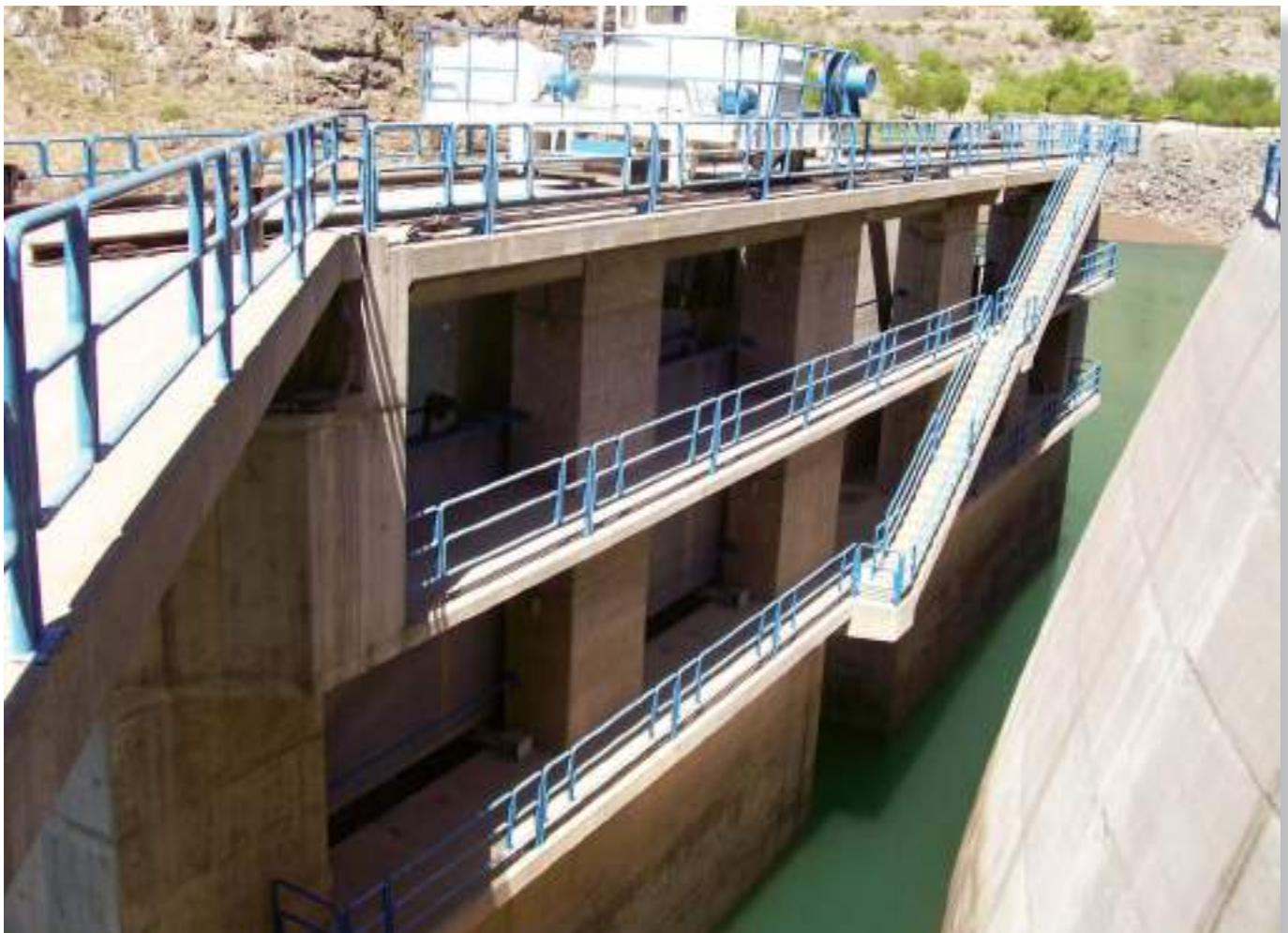
Vista de detalle de la estructura y las compuertas de cierre de los conductos de restitución de la central al río.
