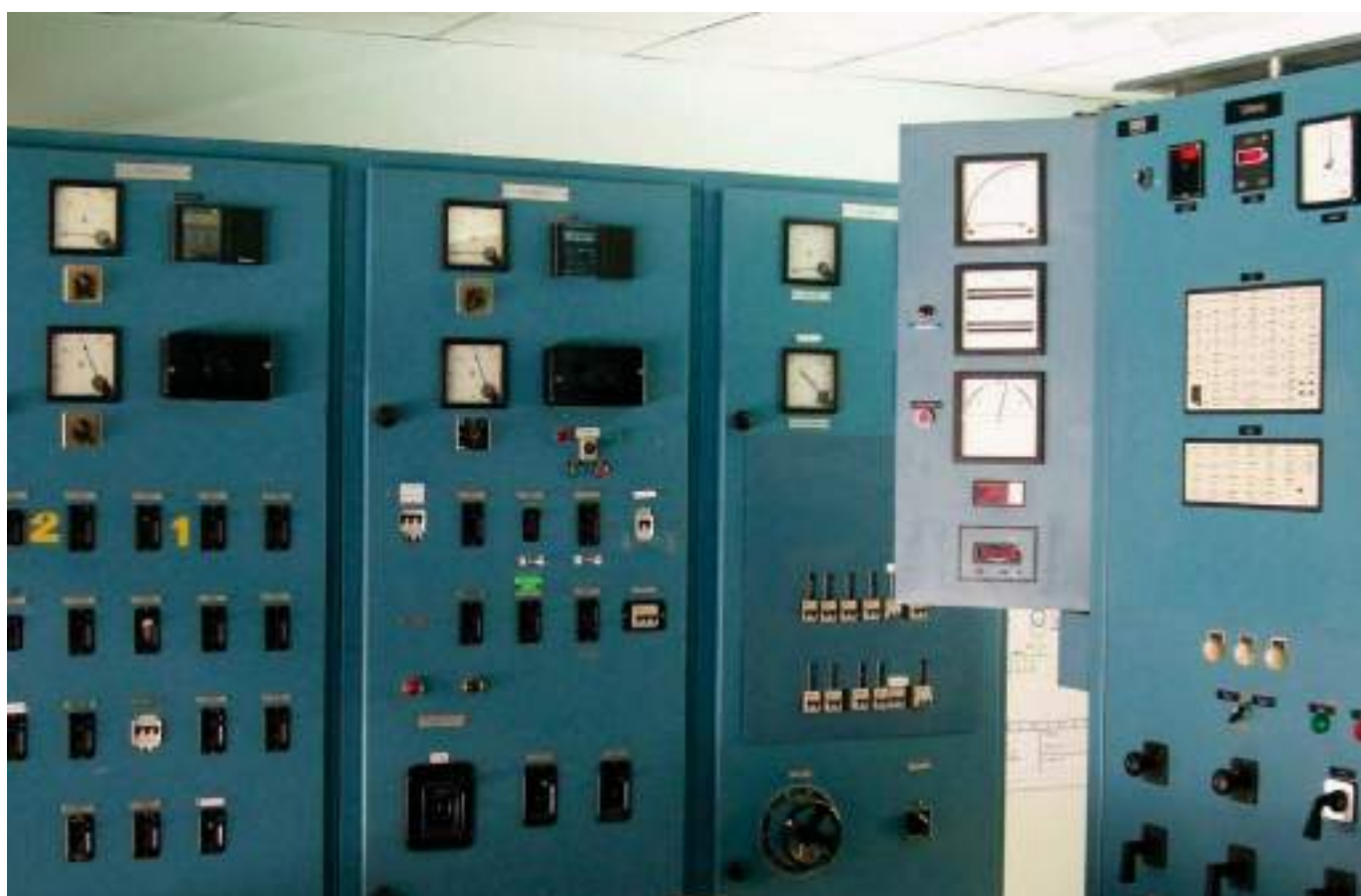
Vista general de la sala de comando.
