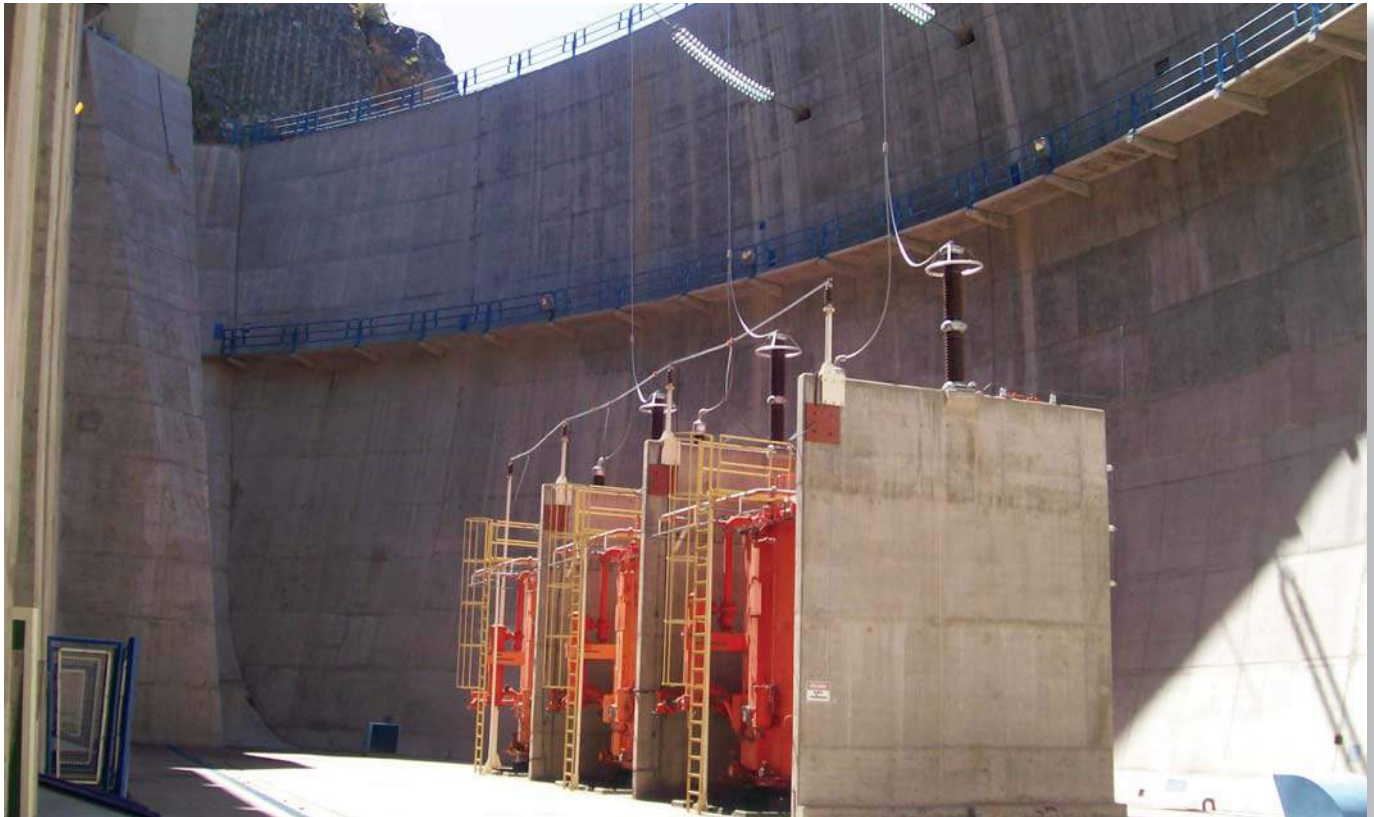
Vista de la playa de transformadores, dentro del escudo de protección de los niveles de contraembalse de la presa El Tigre.
