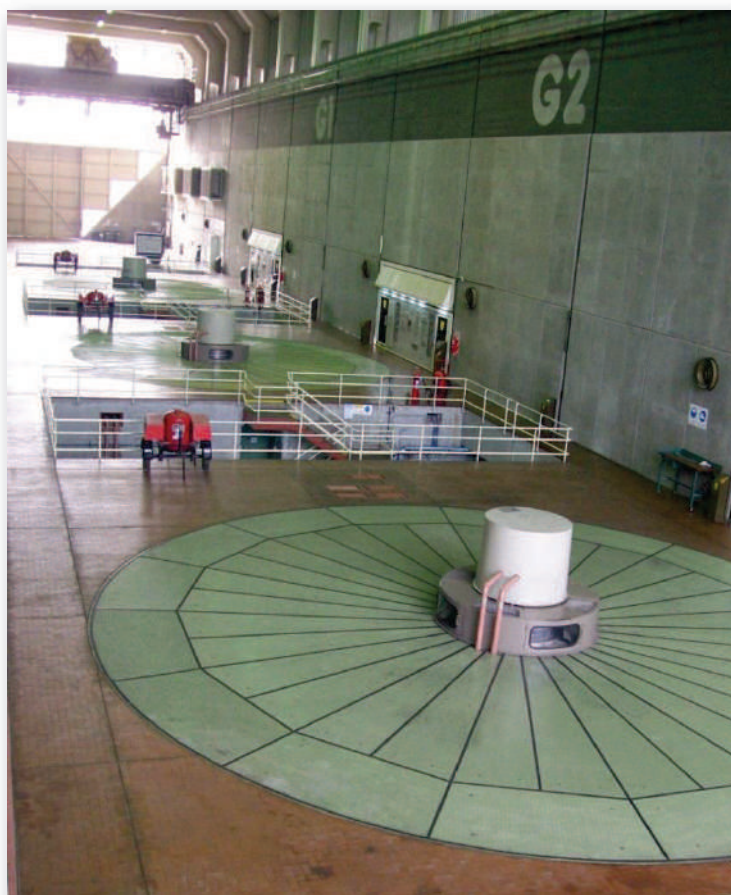
Vista de la central con sus tres grupos generadores.
