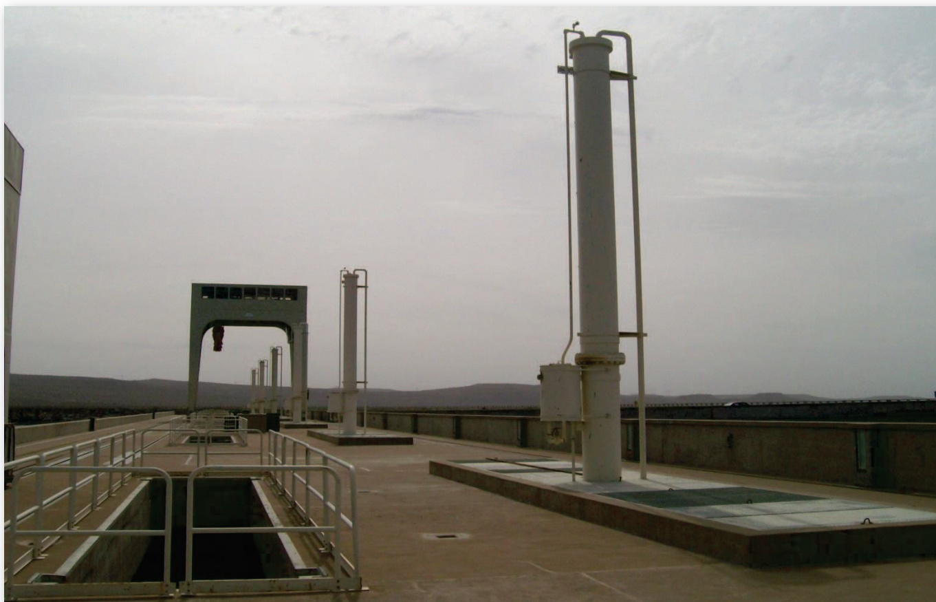
Vista de la obra de toma. A la derecha se aprecian los accionamientos de las compuertas de servicio y a la izquierda las aberturas para colocar las compuertas de mantenimiento.
