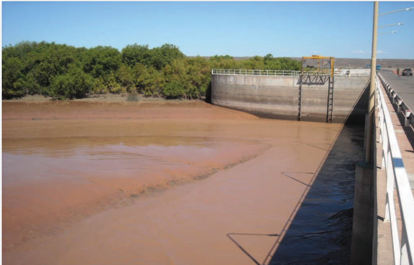
Vista de la margen izquierda del aliviadero, al fondo se aprecia el sistema de limpieza de las rejas para la descarga de riego del dique Portezuelo Grande. Gentileza Duke Energy Cerros Colorados S. A.
