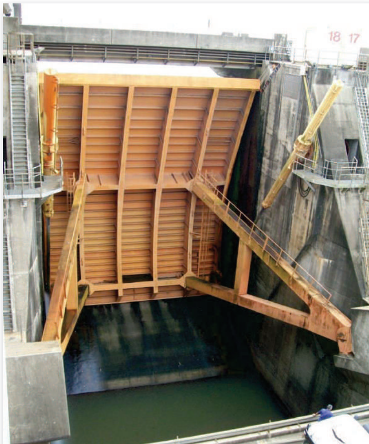
Vista de una de las 18 compuertas de sector del aliviadero del brazo principal.
