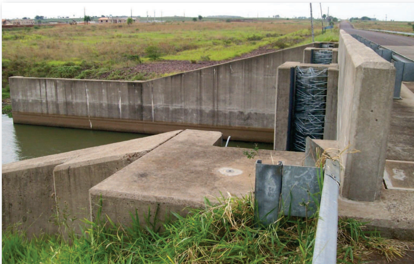
Vista de la salida de la toma para riego.
