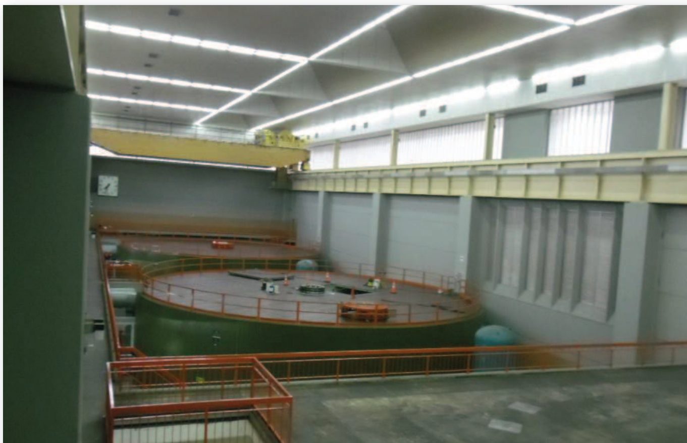
Vista de la central con sus dos grupos generadores.
