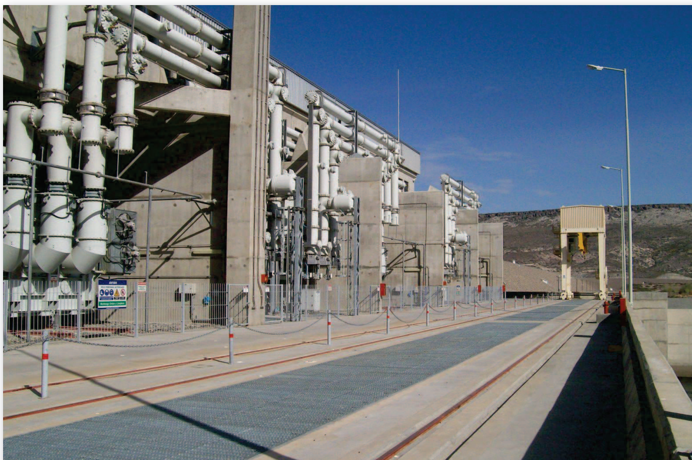
Vista del parque de transformadores de la central. Bajo las rejillas en primer plano, se colocan las compuertas para mantenimiento (de restitución), mediante el puente grúa que se aprecia al fondo.
