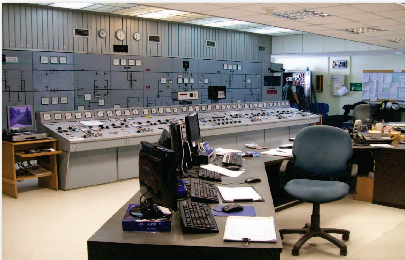
Vista de la sala de comandos del complejo El Chocón.
