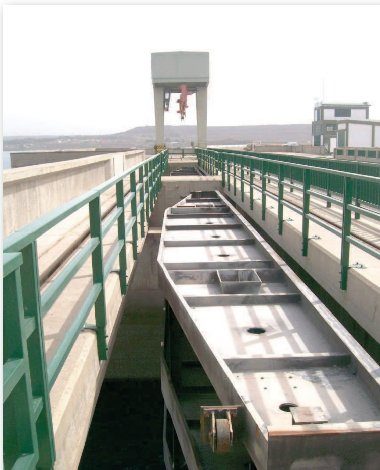
Vista de las compuertas planas de cierre y el puente grúa para su colocación y descenso.
