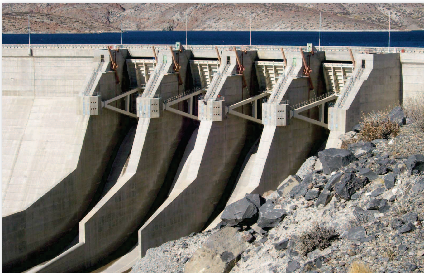
Vista de las cuatro compuertas de sector del vertedero.
