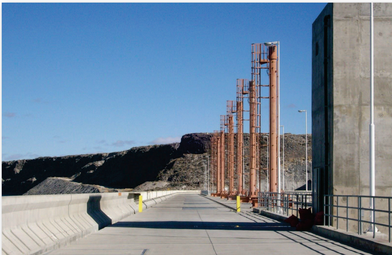
Vista de los accionamientos hidráulicos para las compuertas de las conducciones a central.
