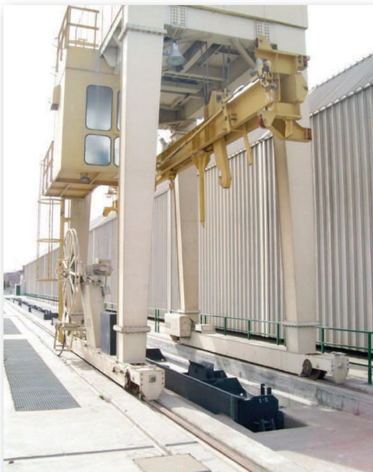
Vista de las compuertas de aguas arriba de la central con su puente grúa para su colocación. Al fondo se aprecia el edificio de la central.
