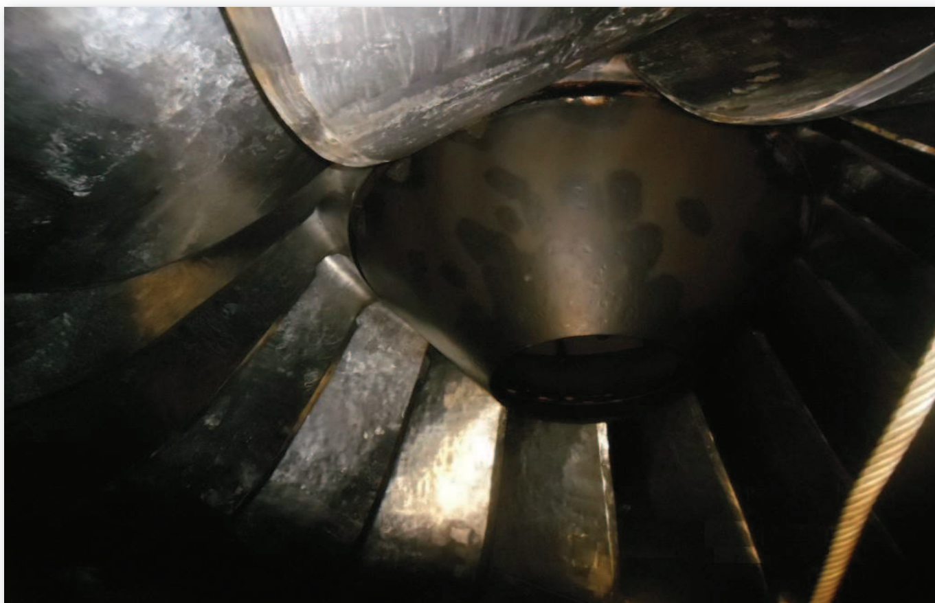
Vista del rotor de la turbina francis, se pueden apreciar los álabes y el cono de salida.
