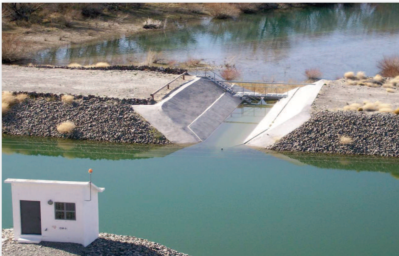
Vista del aforador (para medición de caudales) de filtraciones ubicado inmediatamente aguas abajo de la presa. Nótese su forma triangular.
