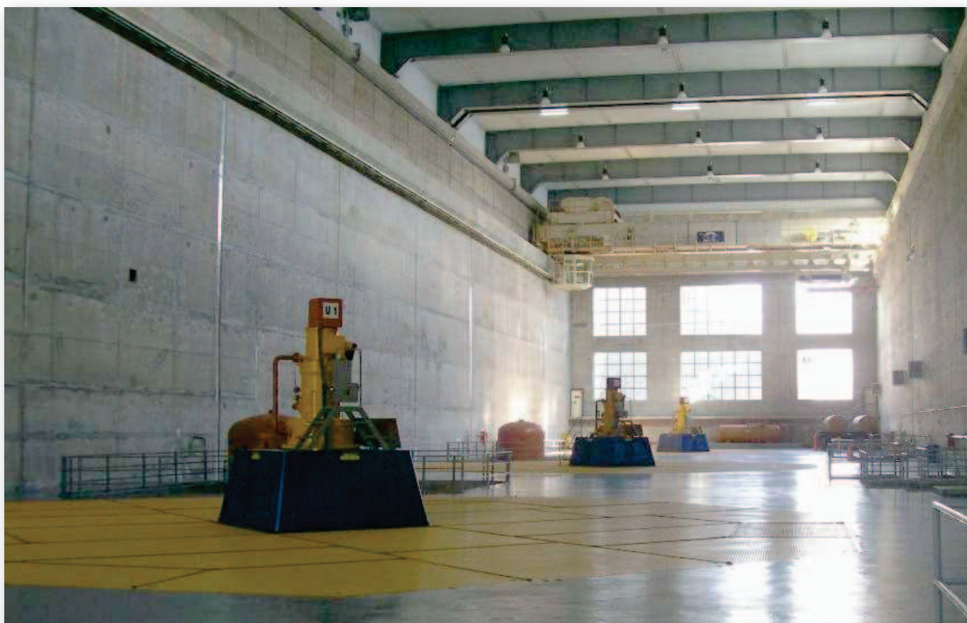
Vista de la central con sus tres grupos generadores.
