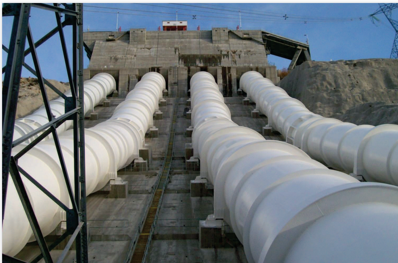
Vista del inicio de las cuatro conducciones a la central desde la toma en la dársena de aducción.
