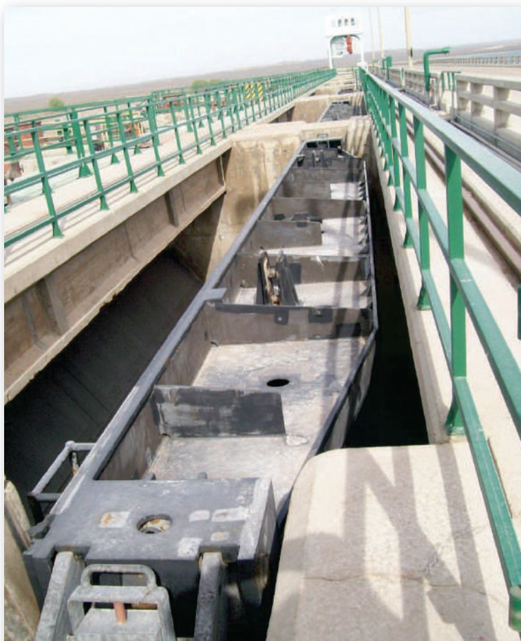
Vista de las una de las compuertas (que cumplen funciones de ataguías), para mantenimiento del aliviadero, al fondo se aprecia el puente grúa para su instalación.
