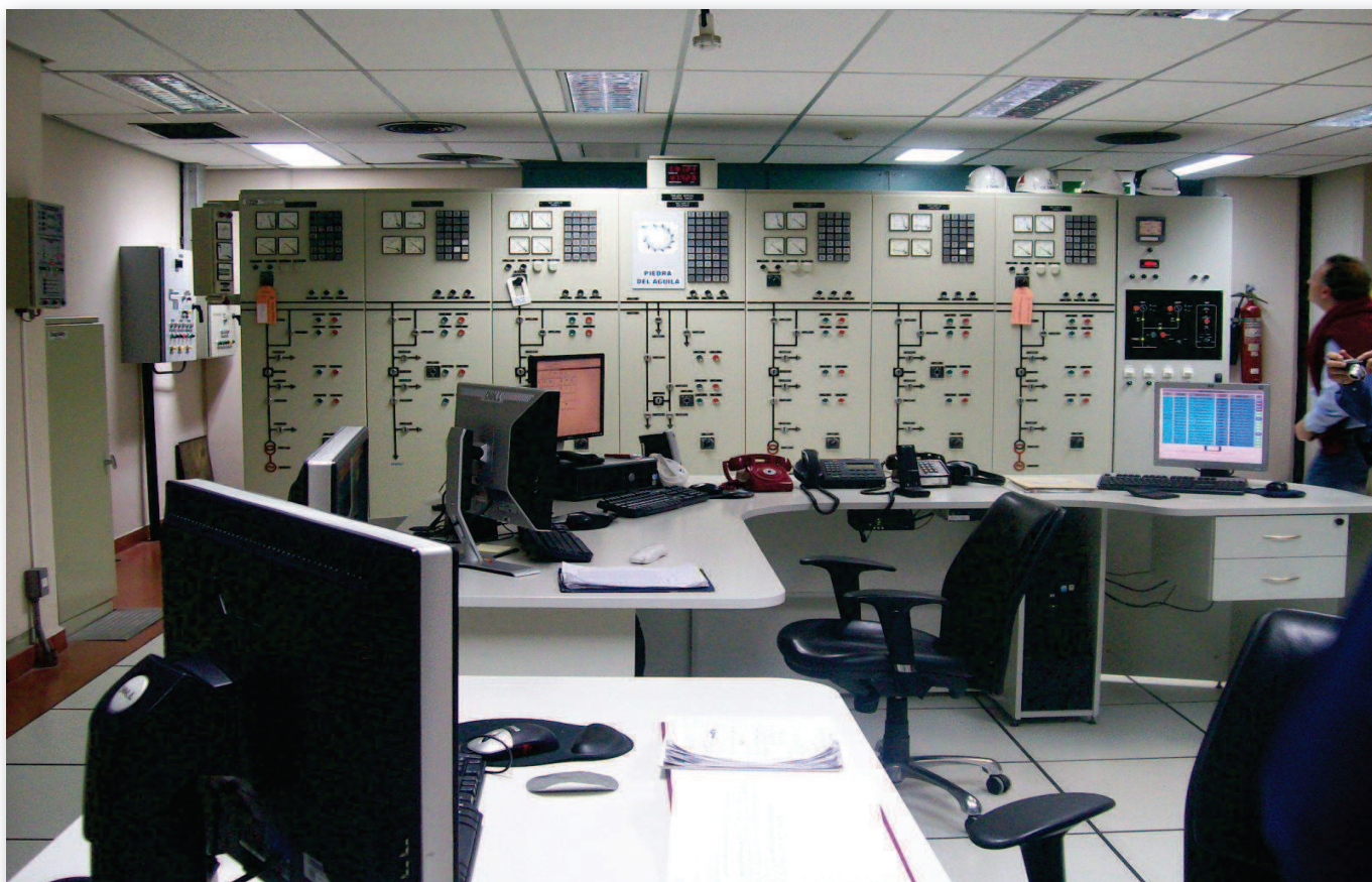
Vista de la sala de comandos del complejo Piedra del Águila.
