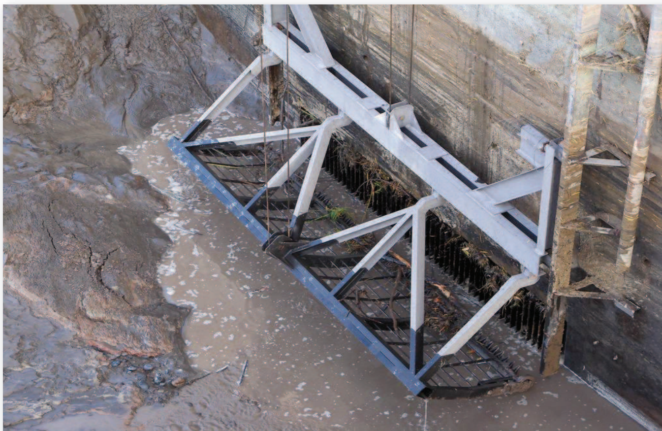
Vista en detalle del sistema de limpieza de las rejas para la descarga de riego del dique Portezuelo Grande. Gentileza Duke Energy Cerros Colorados S. A.
