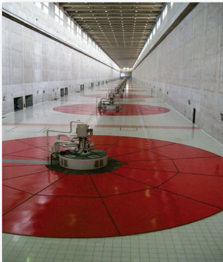
Vista de la central con los 20 grupos generadores.
