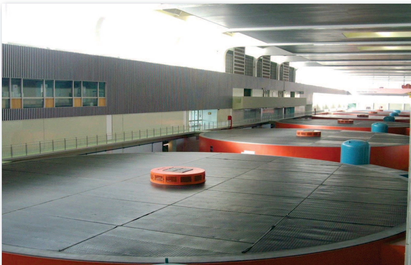
Vista de la central con los seis grupos generadores.
