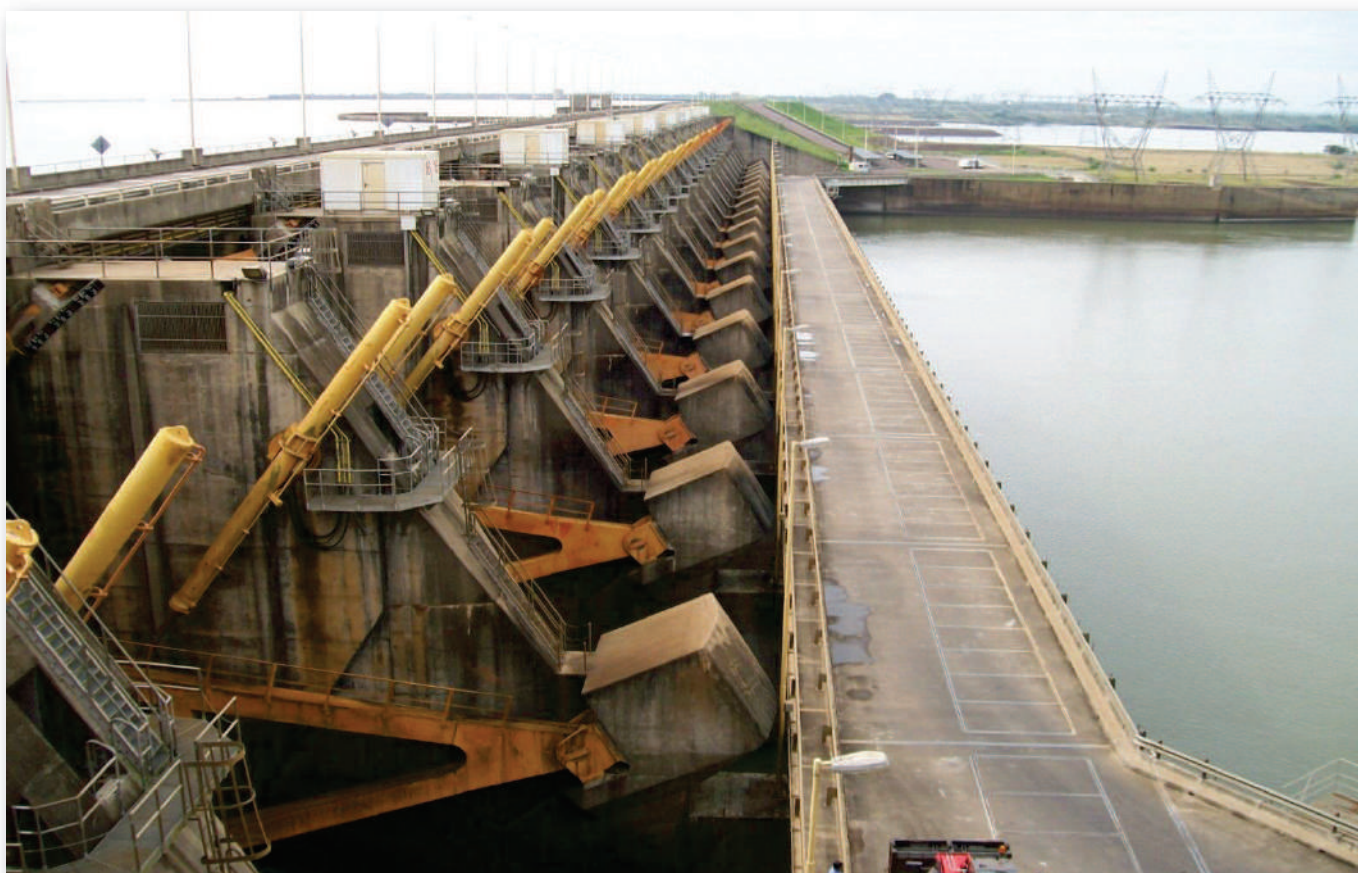
Vista del aliviadero del brazo principal, se observan los apoyos de los brazos de las compuertas con el accionamiento hidráulico de cada compuerta.
