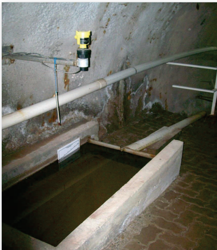
Vista del dispositivo para medir el nivel de agua en la pileta de recepción de agua producto de filtraciones aguas arriba del eje de la presa. Este se ubica en el túnel excavado con posterioridad a la construcción de la presa.
