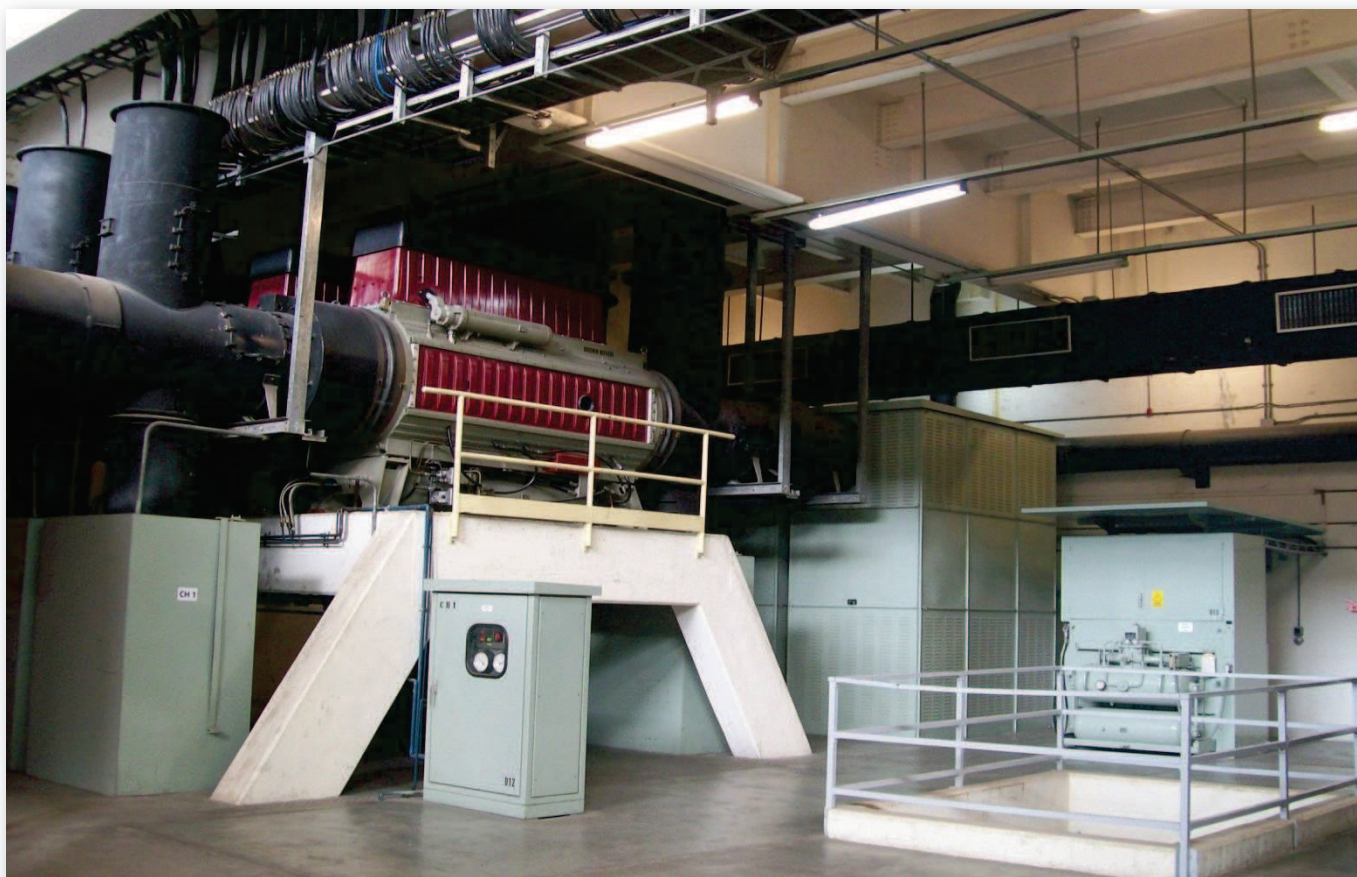
Mecanismo que manda a tierra la generación en caso de desconexión.
