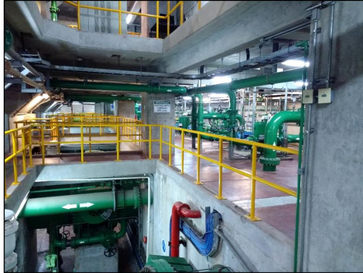
Figura N°18: Pisos intermedios en Central Hidroeléctrica Cacheuta (Mendoza, Argentina).
