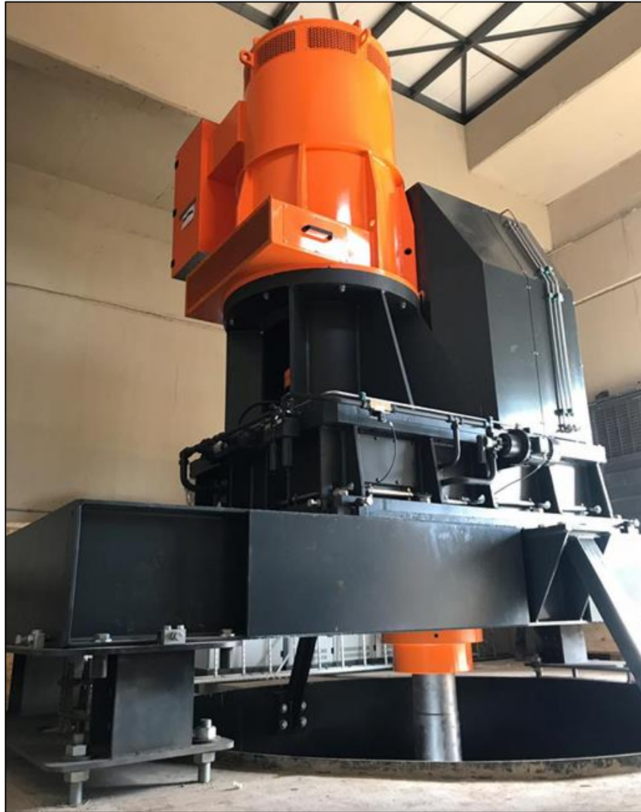
Figura N°46: Grupo Turbogenerador de una Minicentral.
