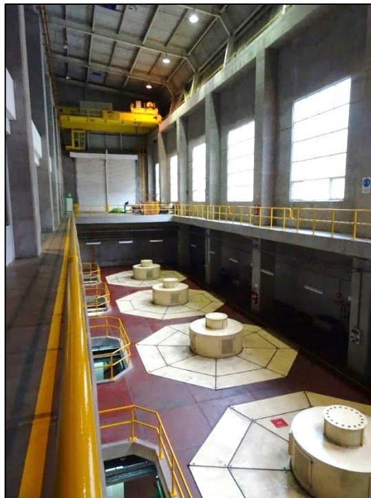
Figura N°19: Piso principal de la Central Hidroeléctrica Cacheuta (Mendoza, Argentina).
