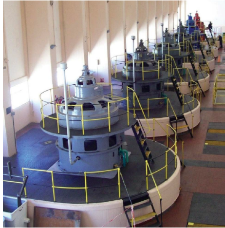
Figura 62. Vista de los seis generadores de la central Nihuil II
