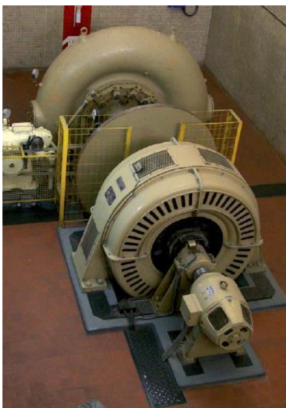
Figura 54. Vista de la turbina Francis de eje horizontal para arranque "en negro"
