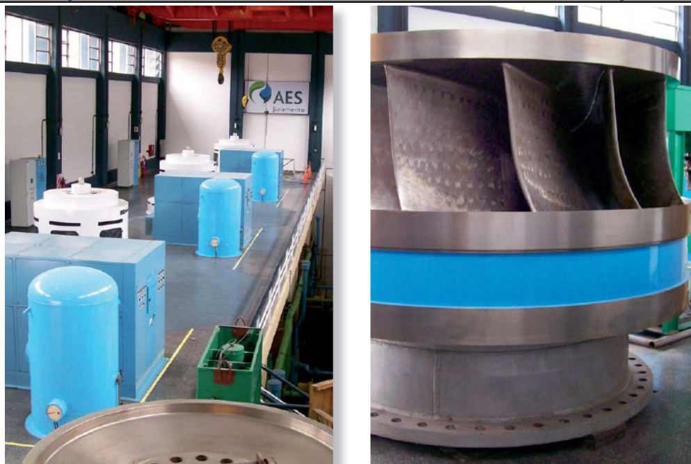
Figura 56. Vista de la central con los tres grupos generadores de la misma, vista del rotor de una de las turbinas Francis
