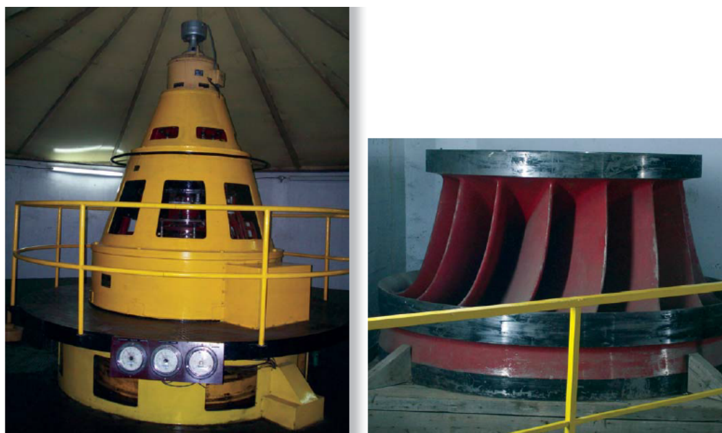
Figura 57. Vista de uno de los grupos generadores, vista del rodete de la turbina Francis
