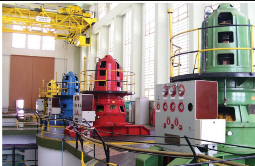
Figura 60. Vista de la central con los cuatro grupos generadores de la central Nihuil I
