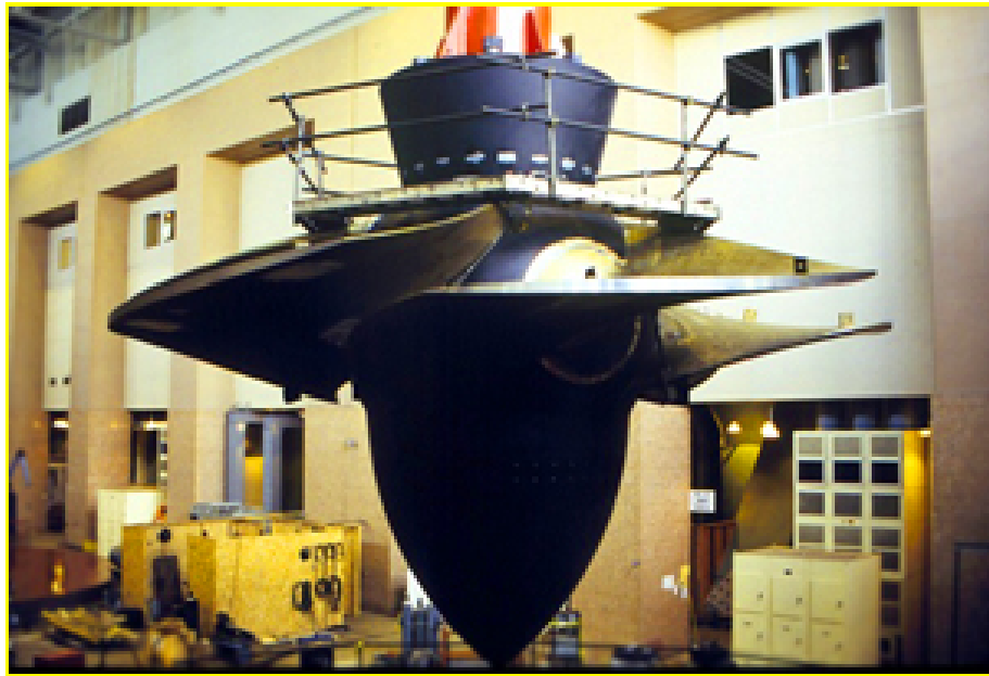
Figura 45. Turbina en casa de maquinas
