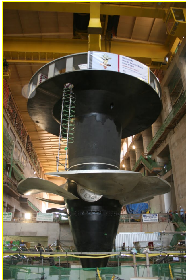
Figura 43. Turbina Kaplan en casa de maquinas.
