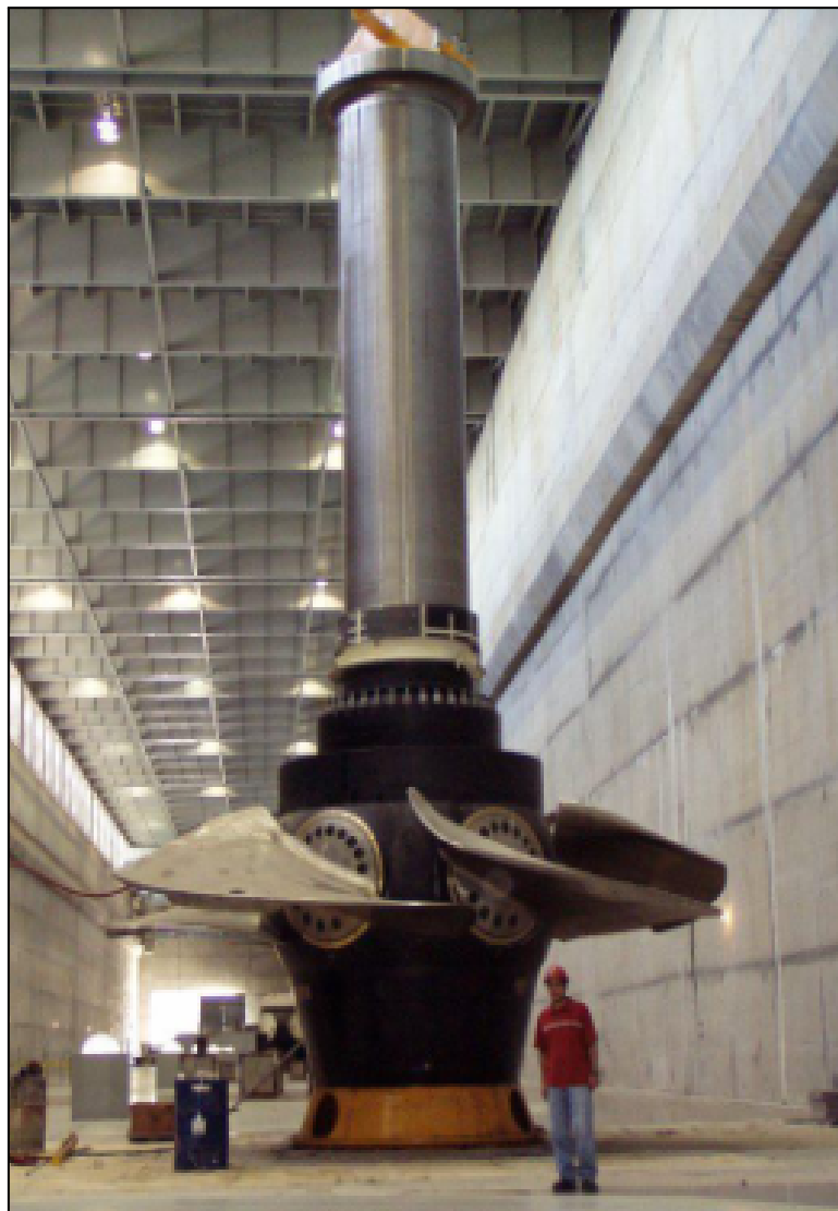
Figura 16. Eje de turbina Kaplan de Caruachi
